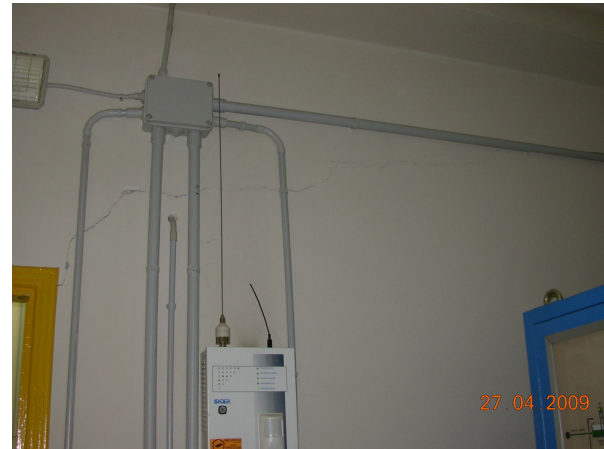
Foto 7 - Impianto Ponte Rosarolo. Ufficio: lesioni ai tramezzi interni.
