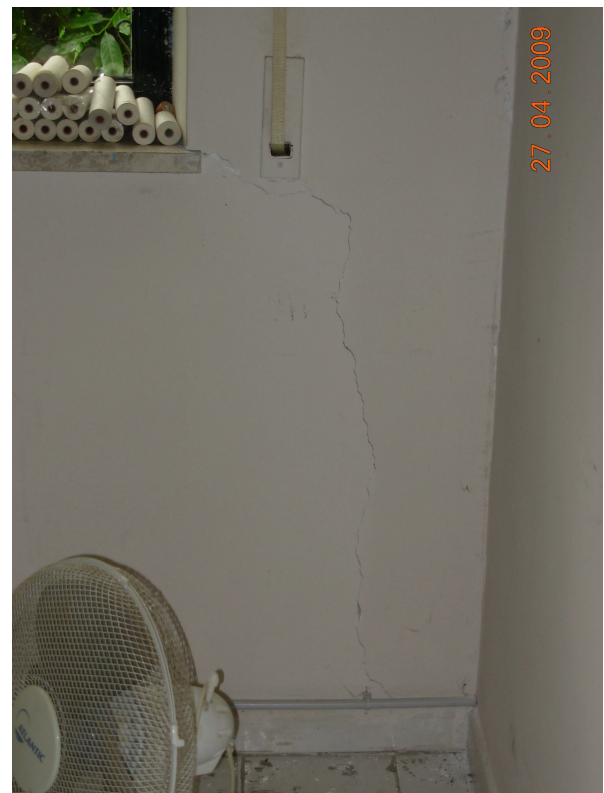
Foto 8 - Impianto Ponte Rosarolo. Locale apparecchiature tecnologiche: lesioni ad un pompagno esterno.
