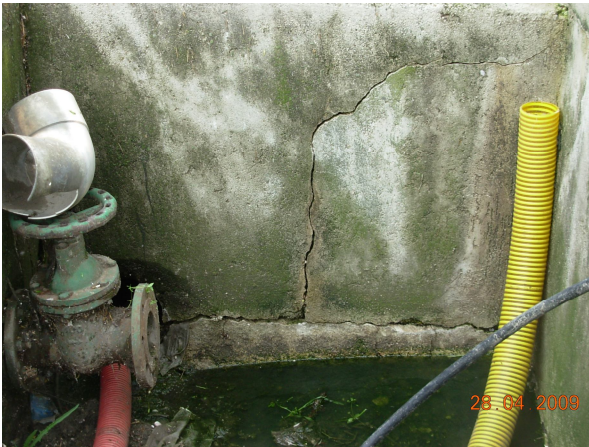
Foto 19 - Impianto Arischia. Pozzetto di distribuzione: lesione ad una parete del pozzetto (vista interna)
