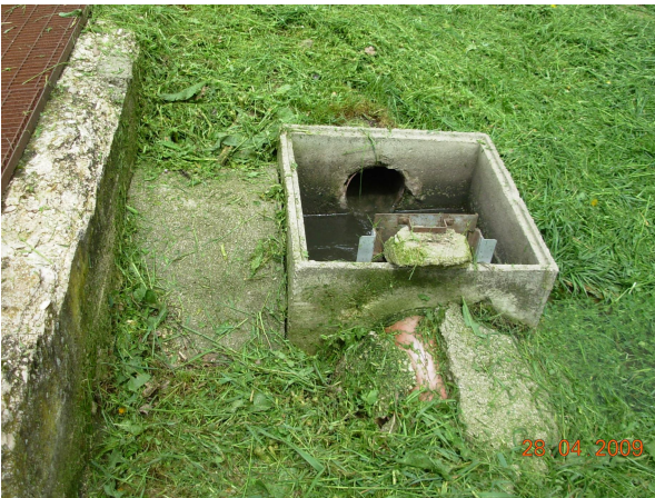
Foto 24 - Impianto Arischia. Pozzetto di uscita. Lieve danneggiamento in corrispondenza dell'innesto dei tubi.
