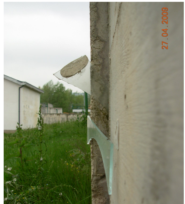
Foto 17 - Impianto di Corfinio. Vasca di areazione. Parete longitudinale. Rotazione verso l'esterno della vasca. Vetrini applicati due anni prima del sisma.
