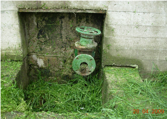
Foto 18 - Impianto Arischia. Pozzetto di distribuzione: lesione ad una parete del pozzetto (vista esterna).
