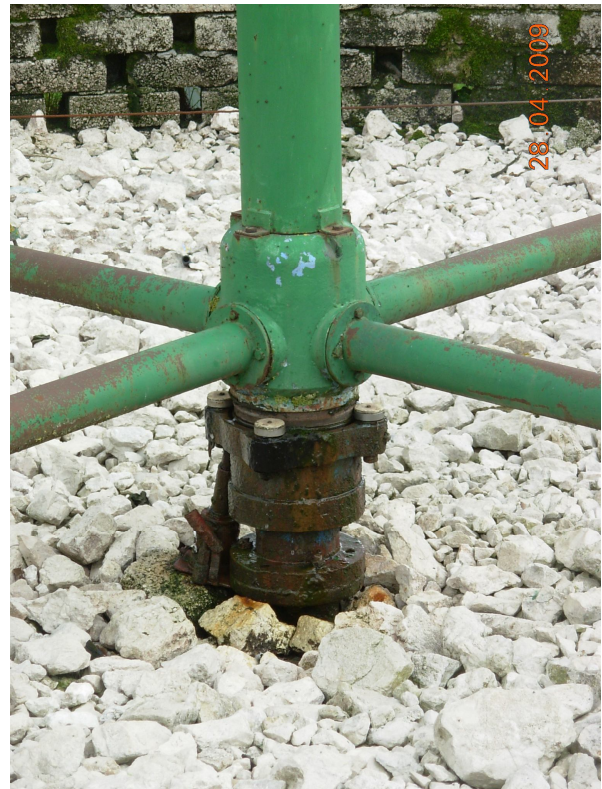
Foto 22 - Impianto Arischia. Vasche circolari di percolazione. Danneggiamento del perno di sostegno dei distributori rotanti.
