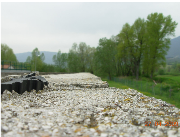
Foto 15 – Impianto di Corfinio. Vasca di areazione. Parete longitudinale. Particolare giunto a tenuta idraulica.
