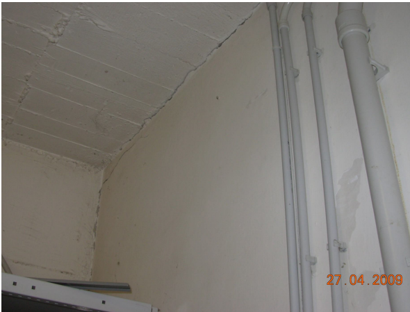
Foto 9 – Impianto Pile. Uffici: lesione al tomagno.
