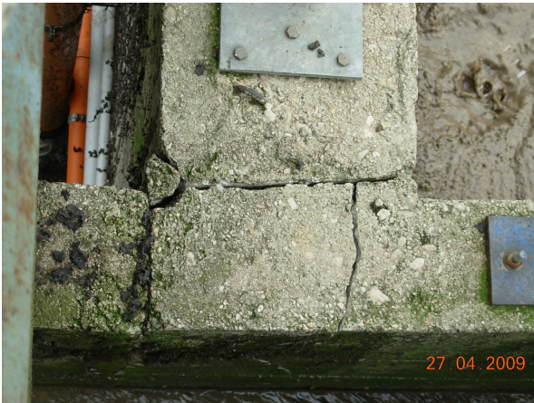
Foto 6 – Impianto Ponte Rosarolo. Vasca di digestione: distacco delle pareti ortogonali in corrispondenza degli spigoli (vista dall'alto.)
