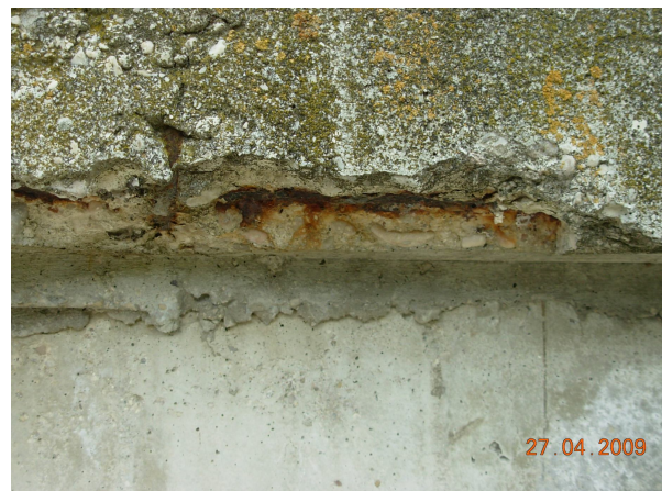
Foto 12 – Impianto Pile. Vasche di sedimentazione: corrosione dell'armatura del cordolo superiore.
