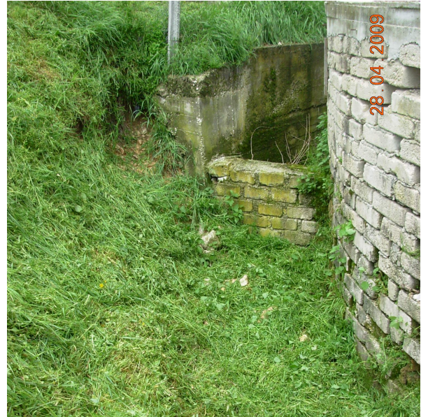
Foto 21 - Impianto Arischia. Danneggiamento al muro di sostegno a gravità.
