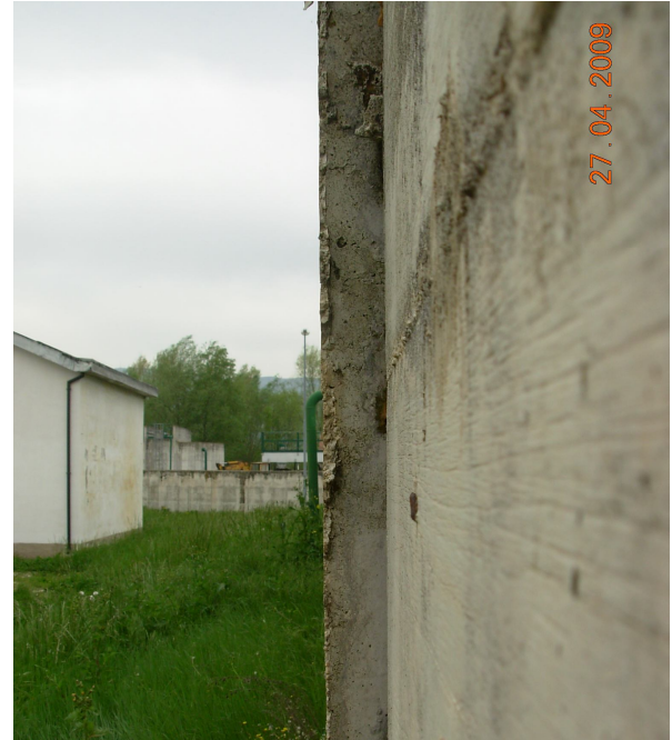
Foto 16 - Impianto di Corfinio. Vasca di areazione. Parete longitudinale. Rotazione verso l'esterno della vasca.
