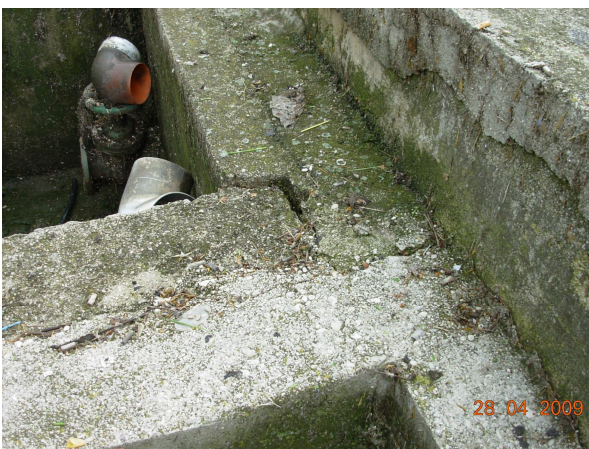
Foto 20 - Impianto Arischia. Pozzetto di distribuzione: lesione ad una connessione tra le pareti del pozzetto (vista interna).
