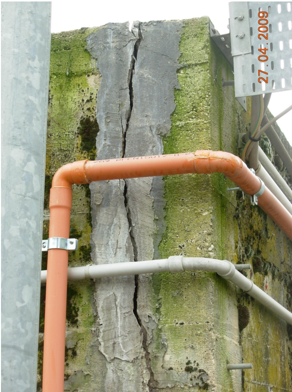
Foto 5 – Impianto Ponte Rosarolo. Vasca di digestione: distacco delle pareti ortogonali in corrispondenza degli spigoli (vista laterale).
