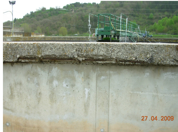
Foto 11 – Impianto Pile. Vasche di sedimentazione: deterioramento del cordolo superiore.
