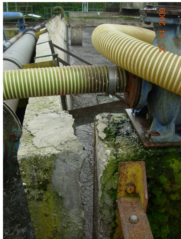
Foto 4 – Impianto Ponte Rosarolo. Vasca di digestione: dettaglio del distacco delle pareti ortogonali in corrispondenza degli spigoli.
