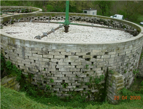
Foto 23 - Impianto Arischia. Vasche circolari di percolazione. Lesioni riscontrate su qualche blocco (precedenti al sisma)
