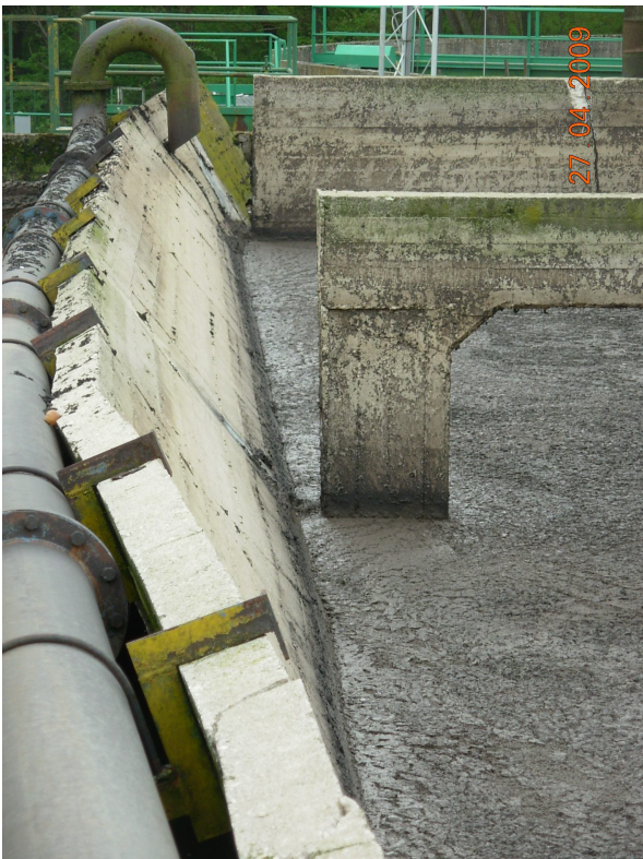
Foto 2 – Impianto Ponte Rosarolo. Vasca di digestione: crollo parziale di una parete longitudinale e della tubazione collegata.
