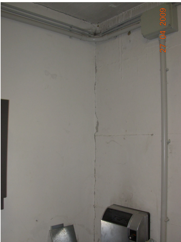
Foto 10 – Impianto Pile. Uffici: lesione ai tramezzi.
