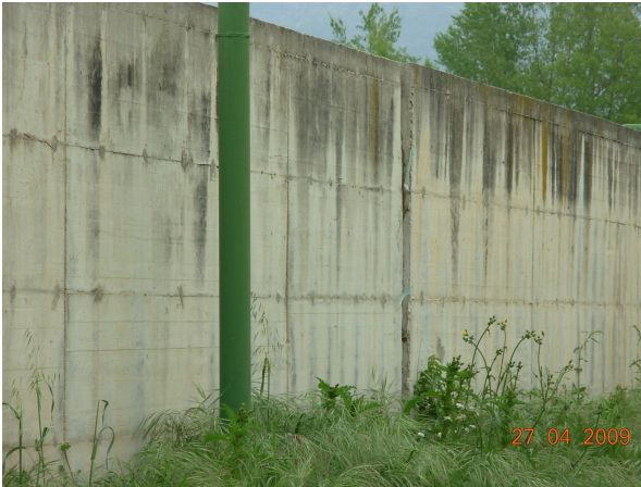
Foto 14 – Impianto di Corfinio. Vasca di areazione. Parete longitudinale. Giunto
