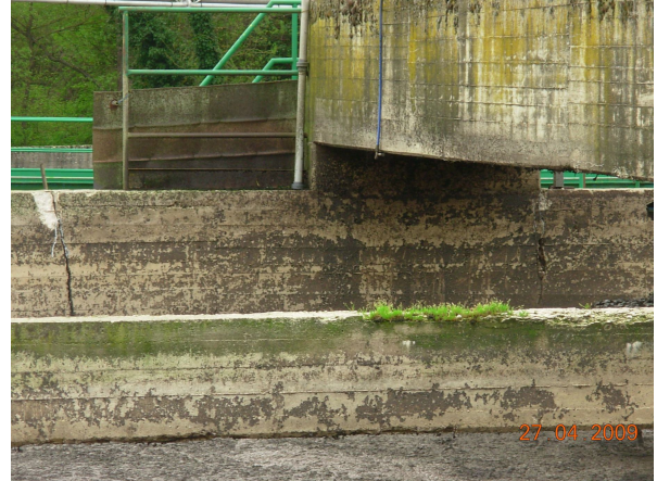
Foto 3 – Impianto Ponte Rosarolo. Vasca di digestione: fessure verticali su una parete trasversale.
