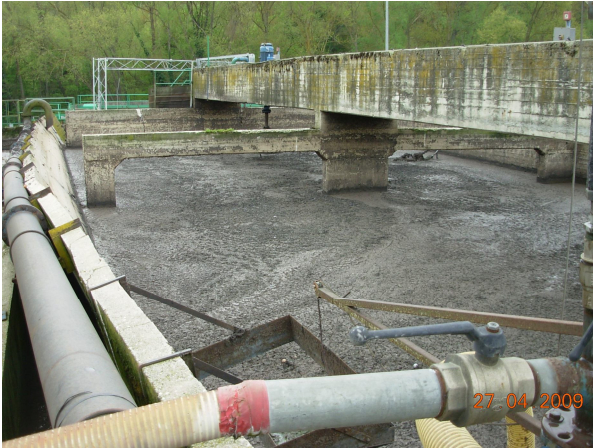
Foto 1 – Impianto Ponte Rosarolo. Vasca di digestione: crollo parziale di una parete longitudinale.
