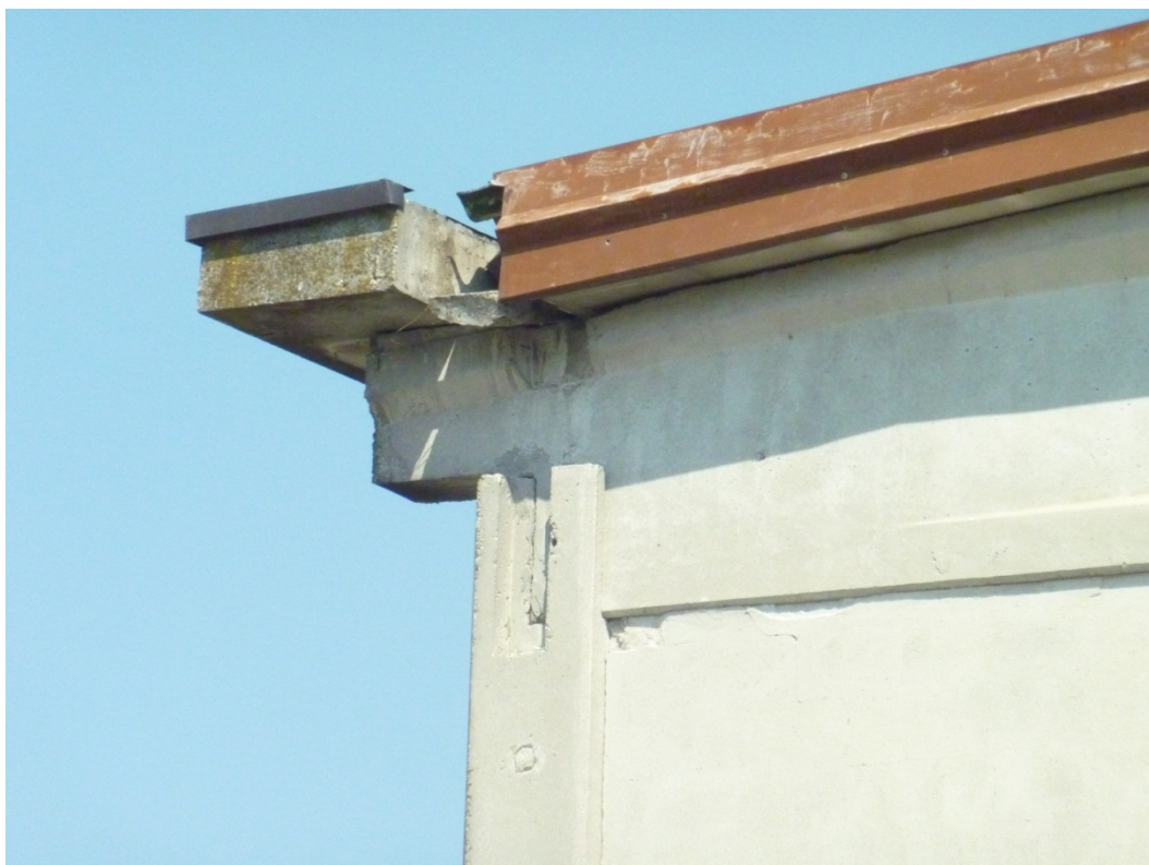
23 Maggio 2012 - S. Felice sul Panaro – Capannone n. 1.
