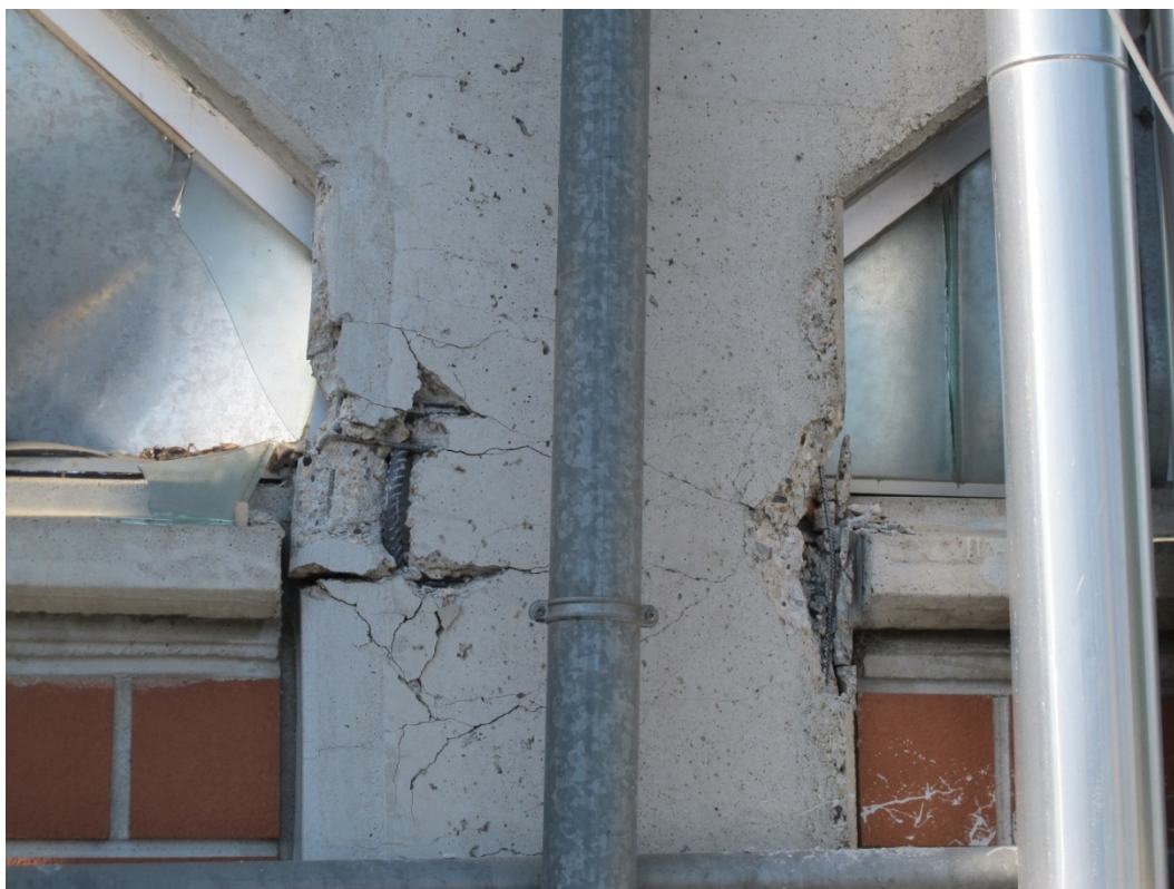
28 Maggio 2012 - S.GR Mirandola – Capannone n. 4 – attività biomedicale – danneggiamento del pilastro tozzo causa interazione con tamponamento.
