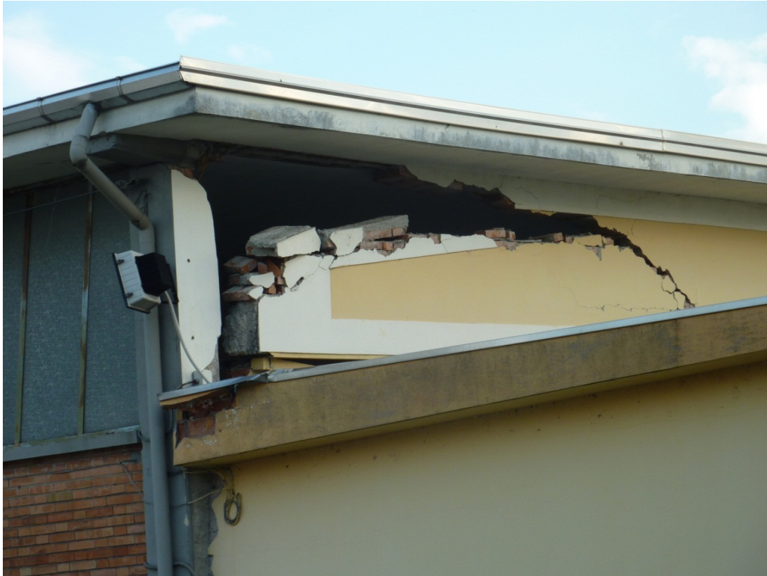
23 Maggio 2012 - S. Agostino – Capannone n. 2 – collasso di tamponatura di facciata.
