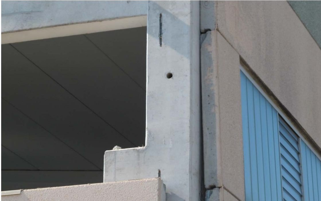
29 Maggio 2012 (dopo 2° sequenza) - Mirandola Nord – Capannone n. 8 – Particolare degli agganci dei pannelli orizzontali.
