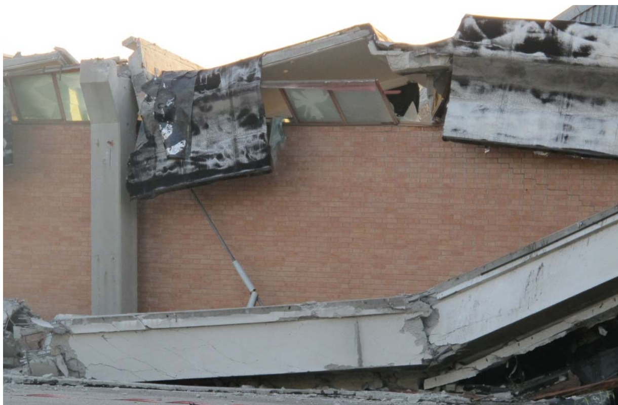
29 Maggio 2012 (dopo 2° sequenza) - S.GR Mirandola – Capannone n. 17.
