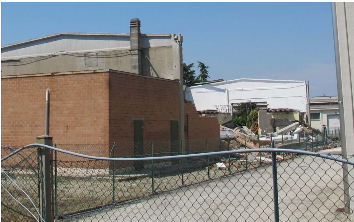
28 Maggio 2012 - S.GR Mirandola – Capannone n. 2 – Collasso di tutte le campate intermedie.
