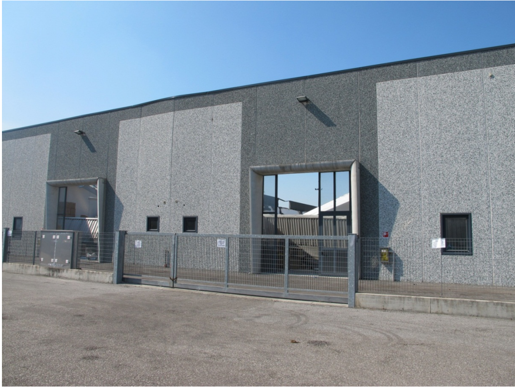
29 Maggio 2012 (dopo 2° sequenza) - Mirandola Nord – Capannone n. 6 – collasso interno con cedimento pilastri interni.
