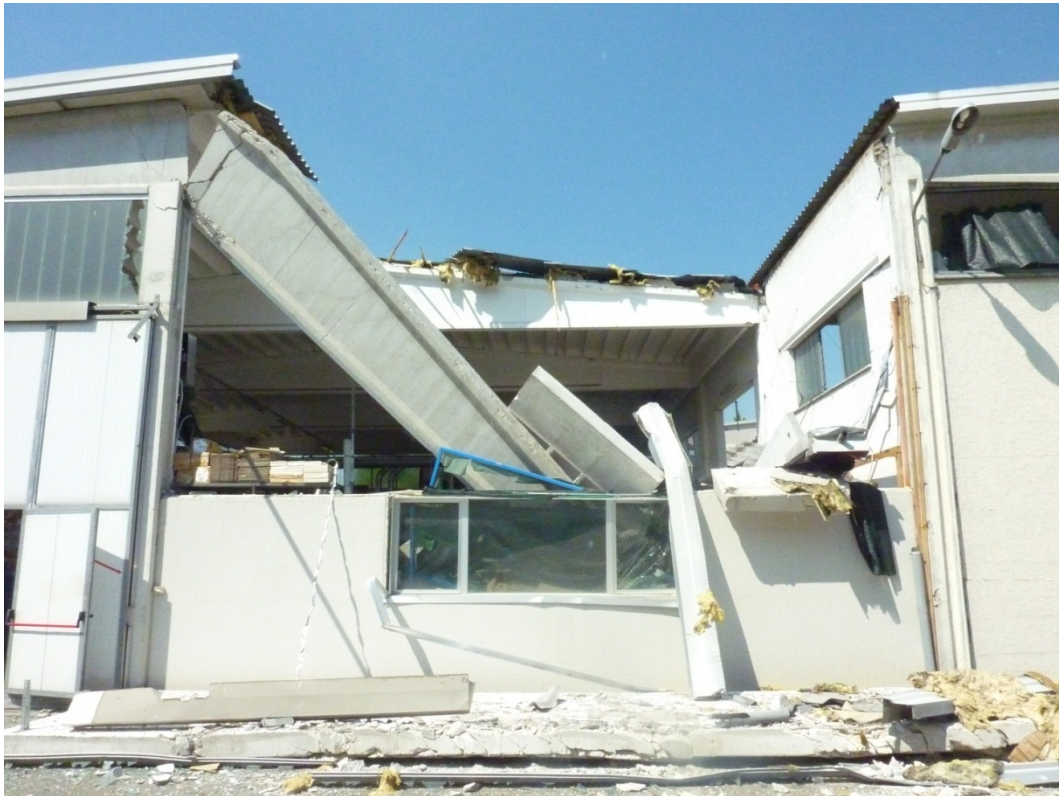
23 Maggio 2012 - S. Felice sul Panaro – Capannone n. 2 sinistra.
