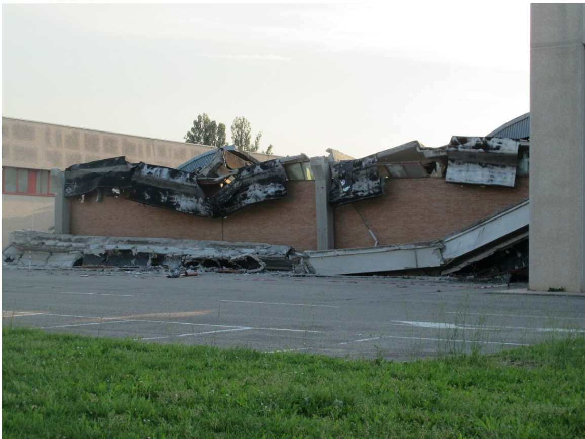
29 Maggio 2012 (dopo 2° sequenza) - S.GR Mirandola – Capannone n. 17.
