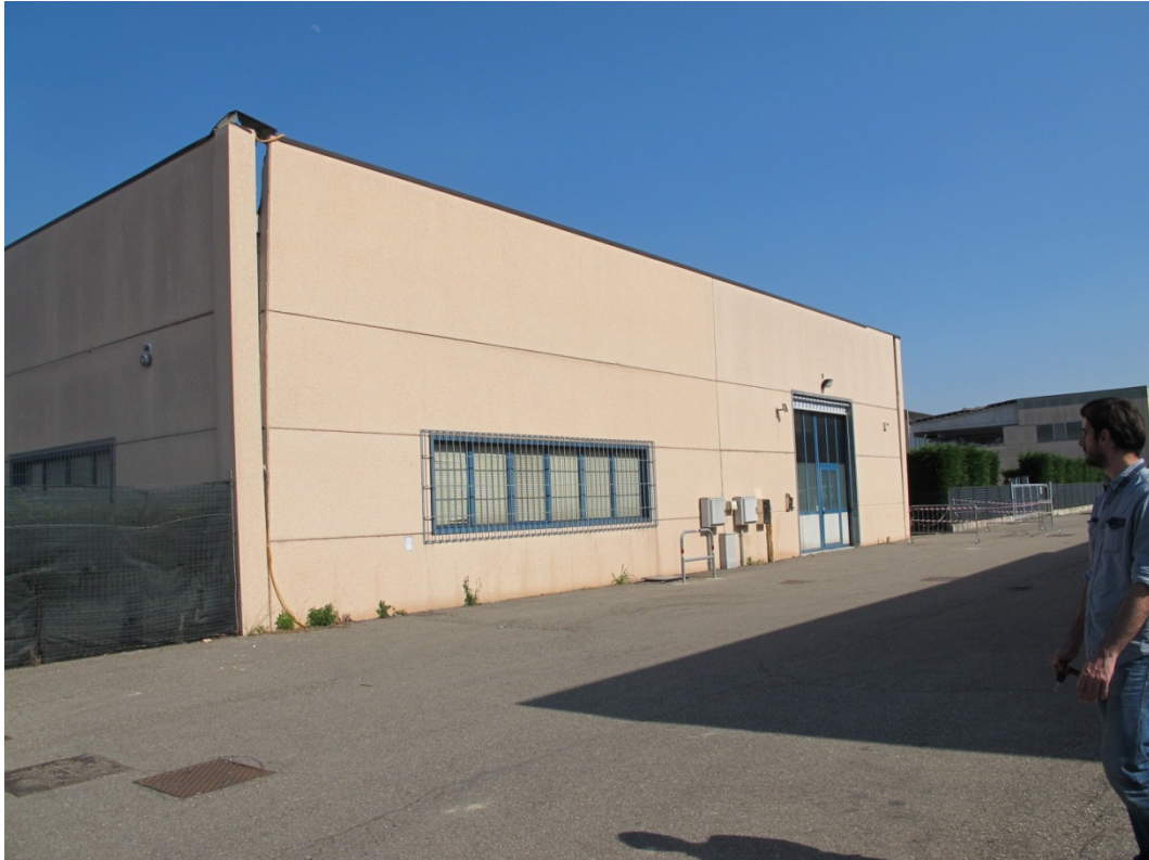
29 Maggio 2012 (dopo 2° sequenza) - Mirandola Nord – Capannone n. 7 – Rotazione di un pilastro di facciata.
