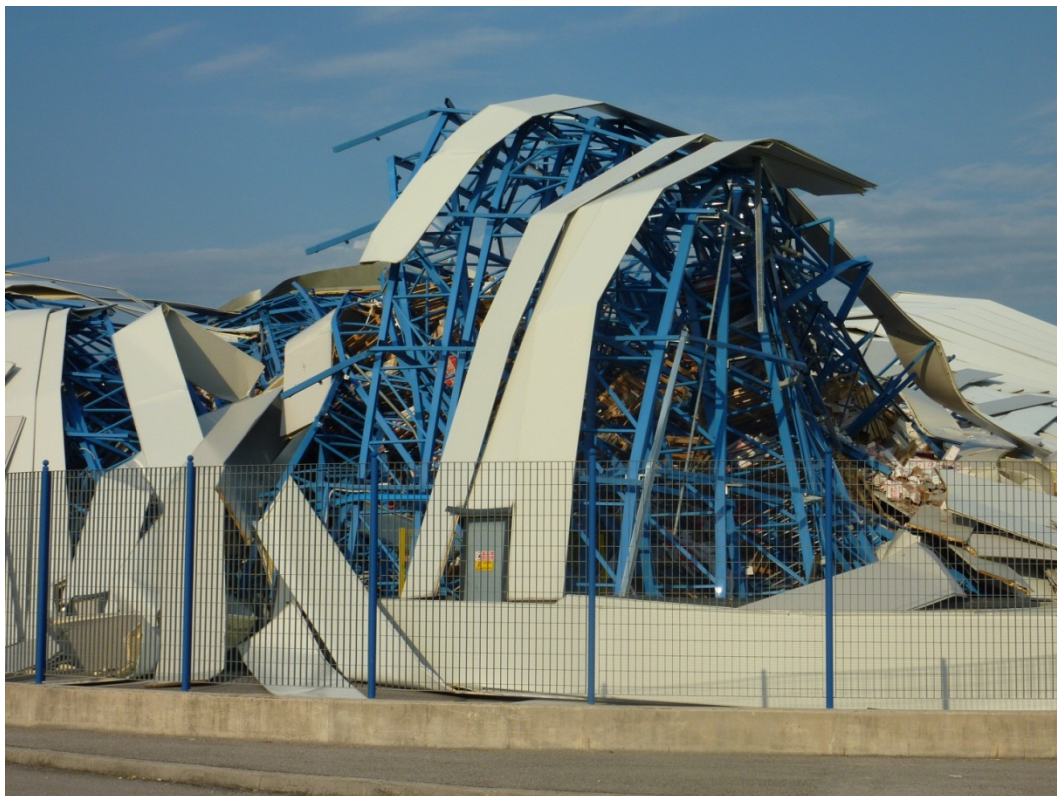
23 Maggio 2012 - S. Agostino – Capannone n. 1 (Ceramiche S. Agostino) – collasso di magazzino automatizzato.
