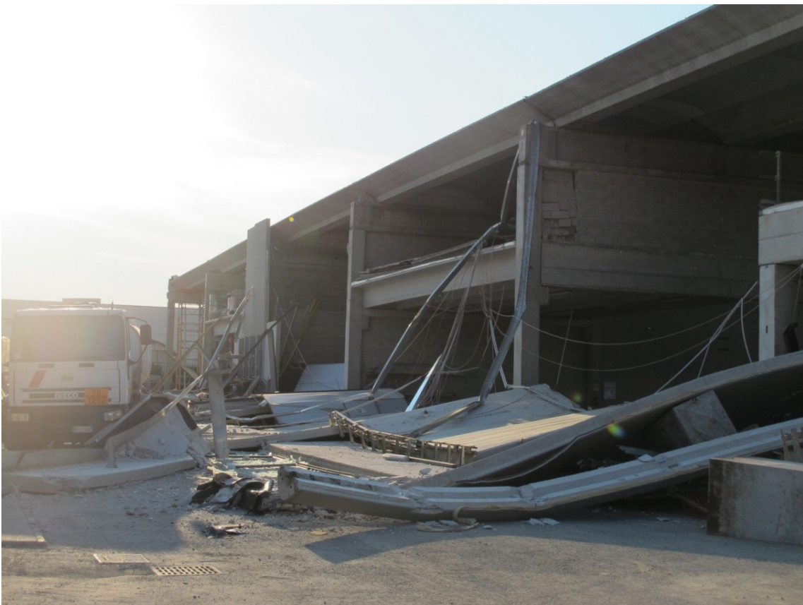
29 Maggio 2012 (dopo 2° sequenza) - S.GR Mirandola – Capannone n. 15.
