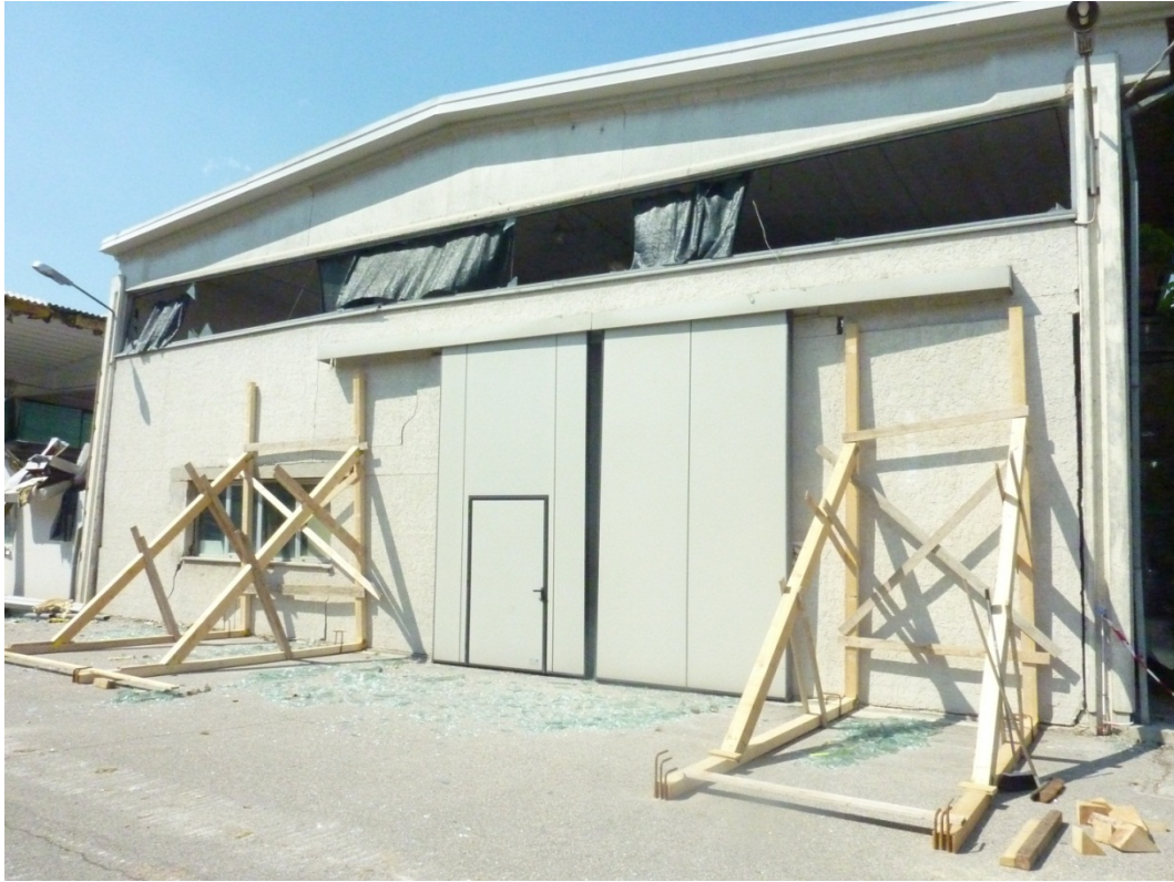
23 Maggio 2012 - S. Felice sul Panaro – Capannone n. 2 destra.
