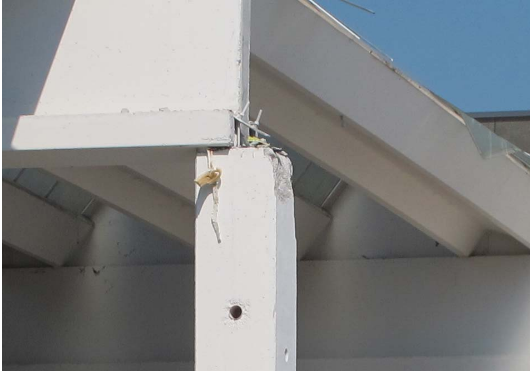
29 Maggio 2012 (dopo 2° sequenza) - Mirandola Nord – Capannone n. 6 – particolare dell'attacco delle travi ai pilastri interni.
