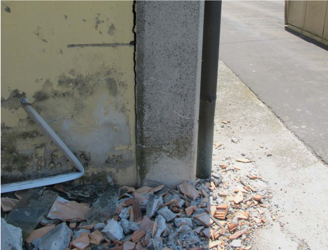
28 Maggio 2012 - S.GR Mirandola – Capannone n. 1 (facciata retrostante) – rotazione alla base del pilastro.
