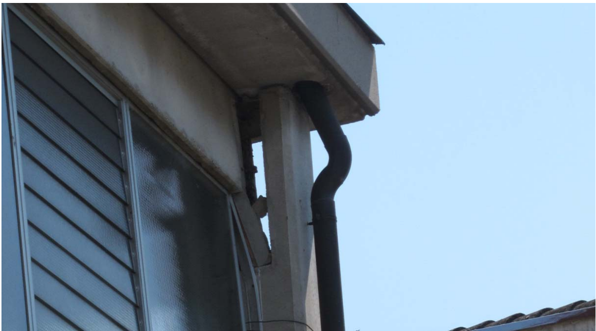
28 Maggio 2012 - S.GR Mirandola – Capannone n. 1 (facciata antistante) – trave con perdita quasi completa dell'appoggio.
