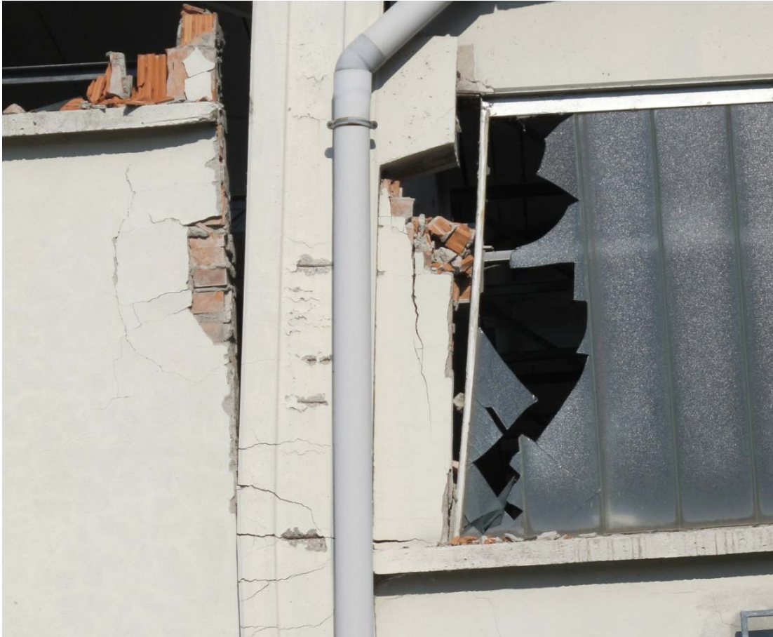
29 Maggio 2012 (dopo 2° sequenza) - S.GR Mirandola – Capannone n. 12 (pilastro centrale).
