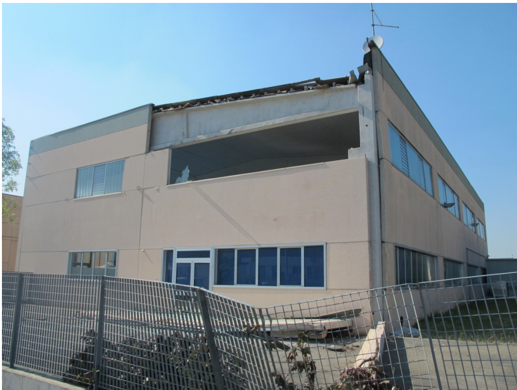
29 Maggio 2012 (dopo 2° sequenza) - Mirandola Nord – Capannone n. 8 – Distacco di due pannelli orizzontali.
