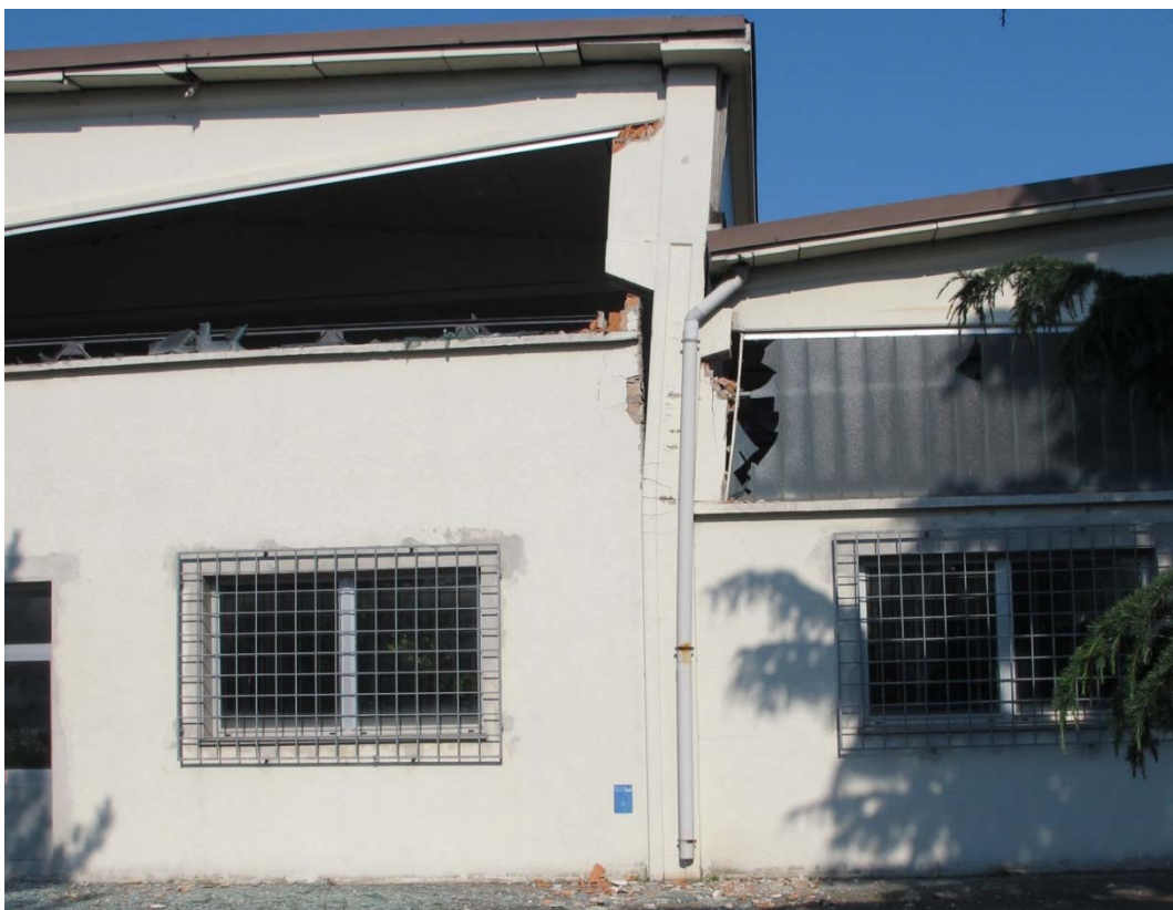
29 Maggio 2012 (dopo 2° sequenza) - S.GR Mirandola – Capannone n. 12 (pilastro centrale).
