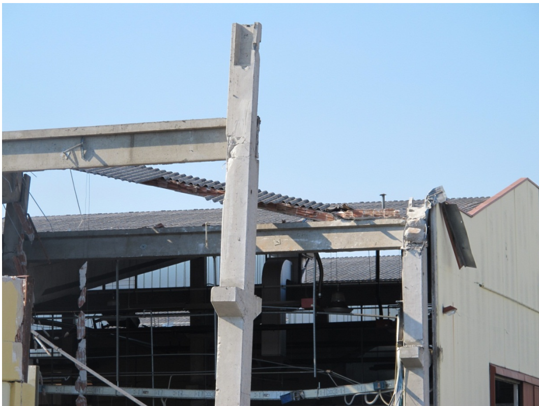
29 Maggio 2012 (dopo 2° sequenza) - S.GR Mirandola (BBG) – Capannone n. 10 (da sud-est).
