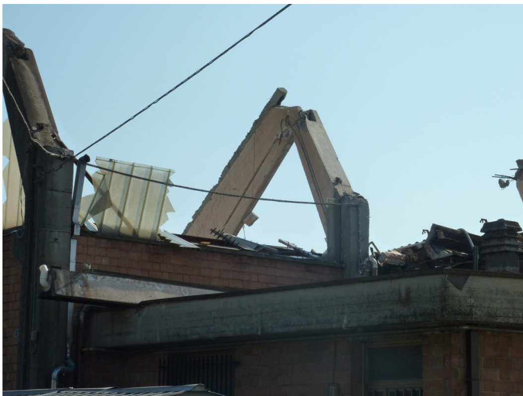
23 Maggio 2012 - S. Felice sul Panaro – Capannone n. 5 (recente).
