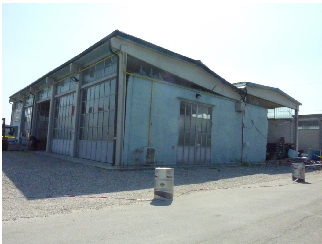
23 Maggio 2012 - S. Felice sul Panaro – Capannone n. 3 sinistra - destra.
