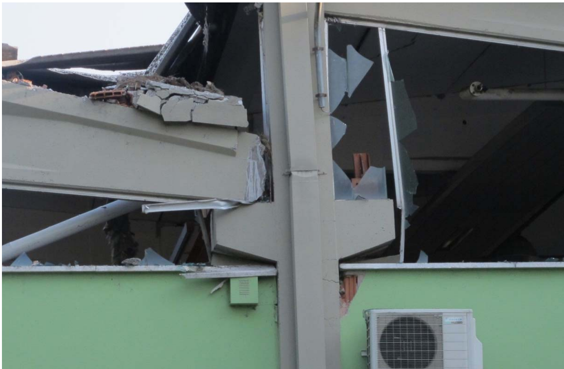
29 Maggio 2012 (dopo 2° sequenza) - S.GR Mirandola – Capannone n. 14 (pilastro centrale).
