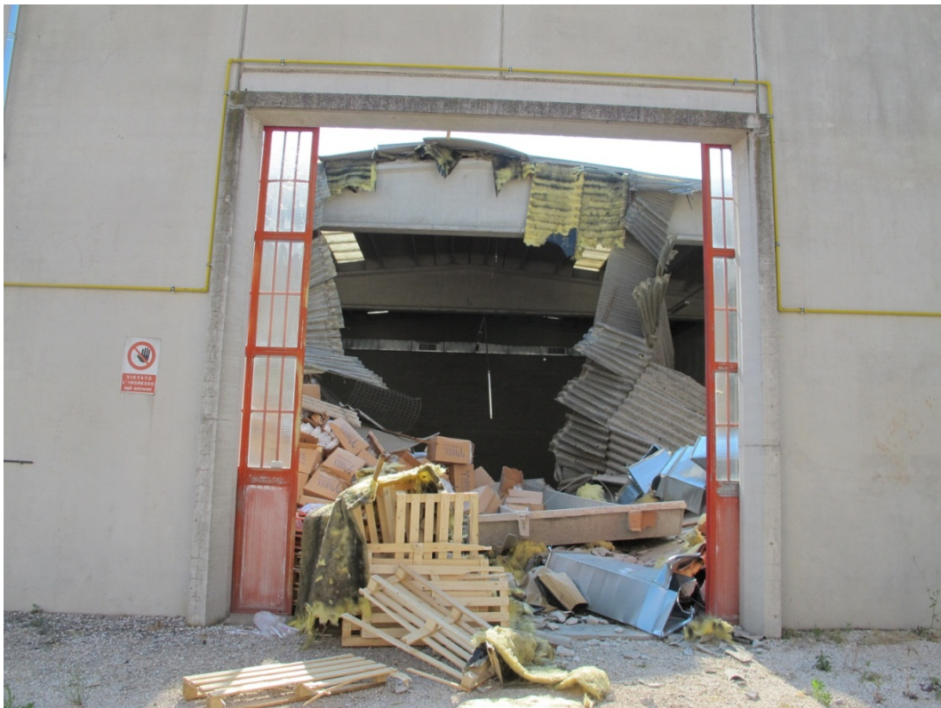
29 Maggio 2012 (dopo 2° sequenza) - S.GR Mirandola (Aries biomedicale) – Capannone n. 9 (lato).
