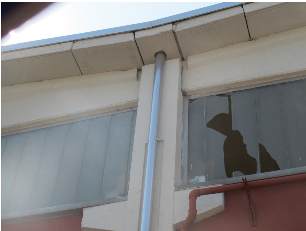
28 Maggio 2012 - S.GR Mirandola – Capannone n. 3 – appoggio delle due travi di facciata – Prima del crollo parziale dopo la seconda sequenza sismica.
