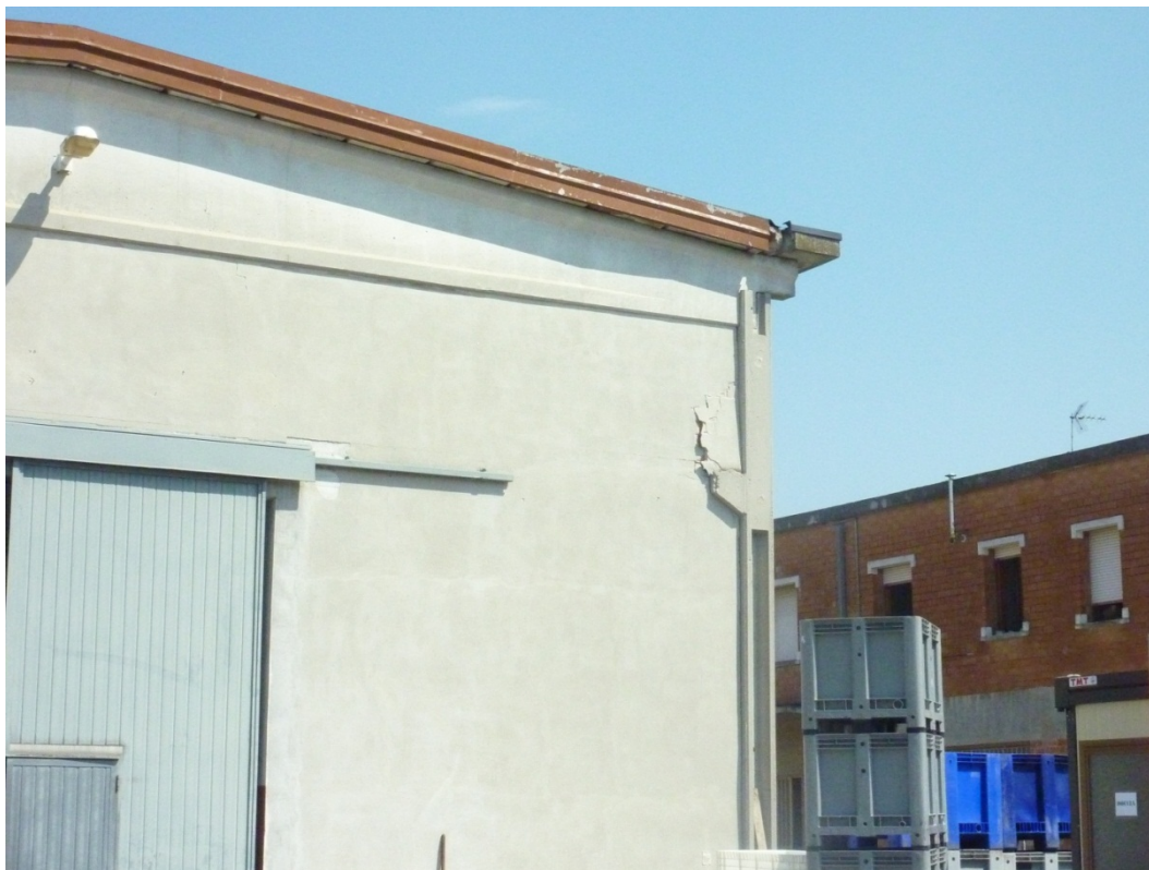
23 Maggio 2012 - S. Felice sul Panaro – Capannone n. 1.
