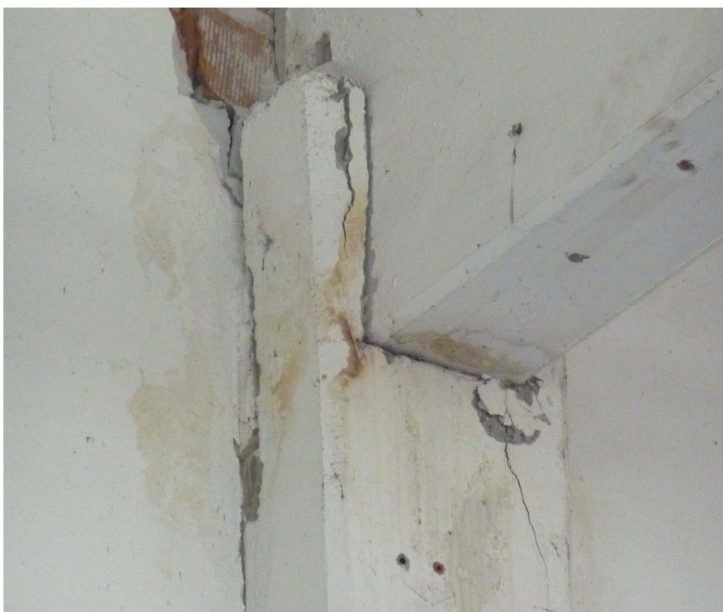
23 Maggio 2012 - S. Felice sul Panaro – Capannone n. 1.
