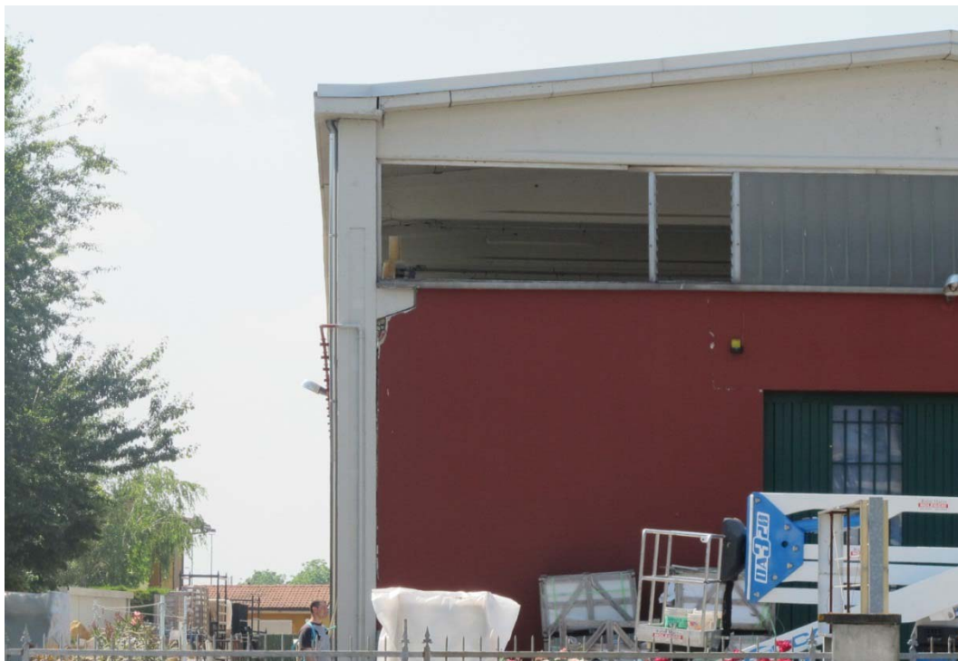
28 Maggio 2012 - S.GR Mirandola – Capannone n. 3 sinistra – Inclinazione del pilastro esterno di facciata, Prima del crollo parziale dopo la seconda sequenza sismica.
