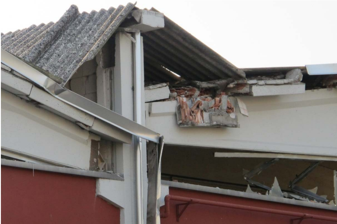
29 Maggio 2012 (dopo 2° sequenza) - S.GR Mirandola – Capannone n. 3 (pilastro centrale).
