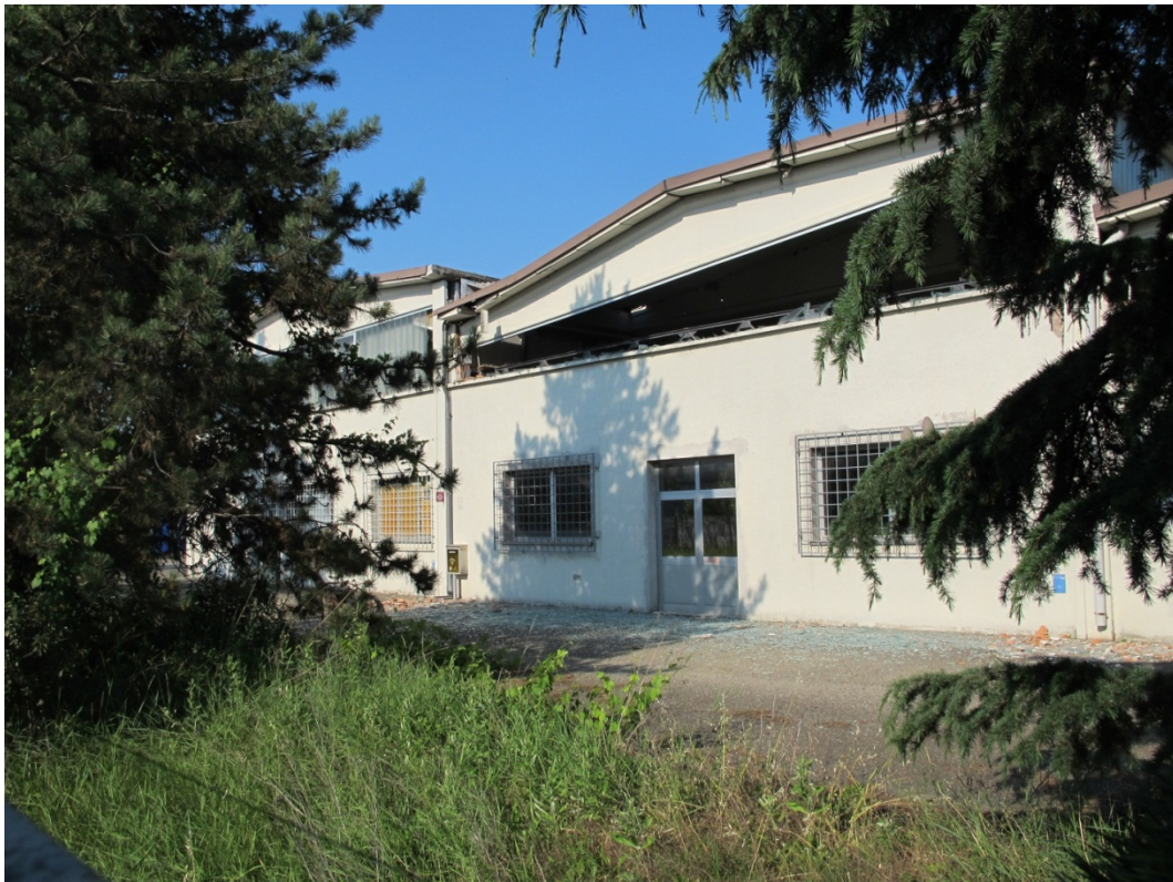
29 Maggio 2012 (dopo 2° sequenza) - S.GR Mirandola – Capannone n. 12.
