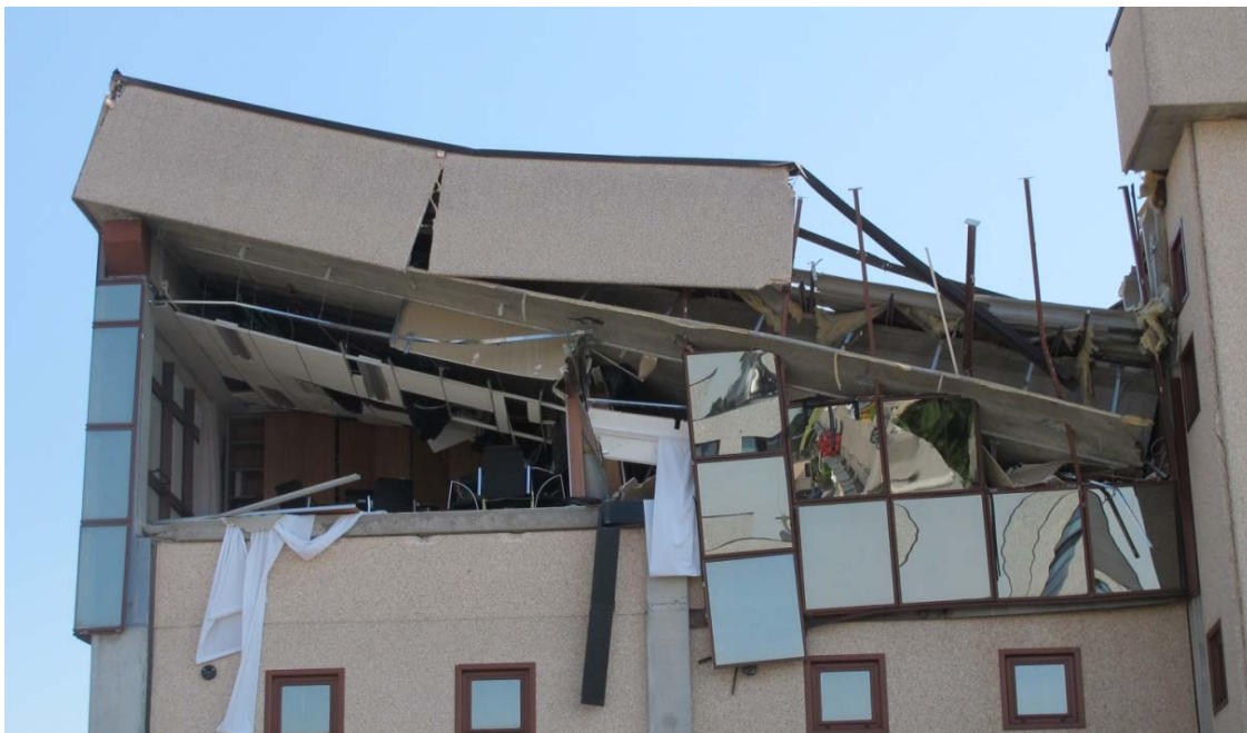
29 Maggio 2012 (dopo 2° sequenza) - Mirandola Nord – Capannone n. 5.
