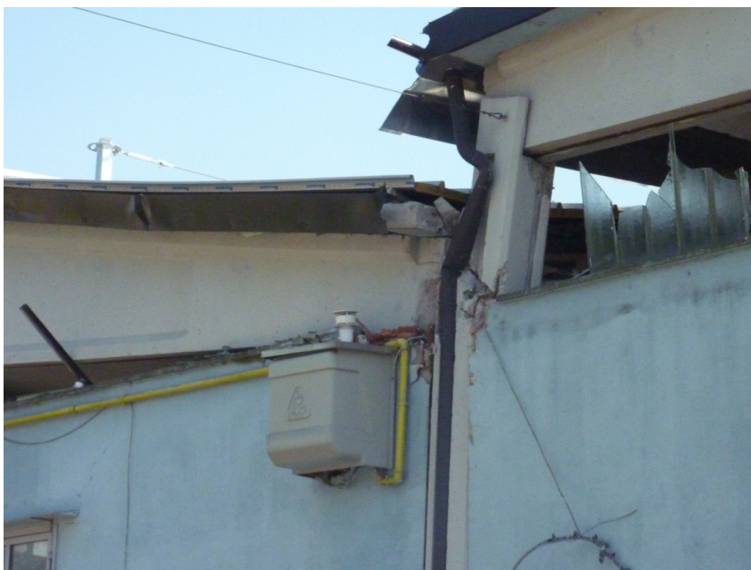
23 Maggio 2012 - S. Felice sul Panaro – Capannone n. 3 destra, cedimento del pilastro.
