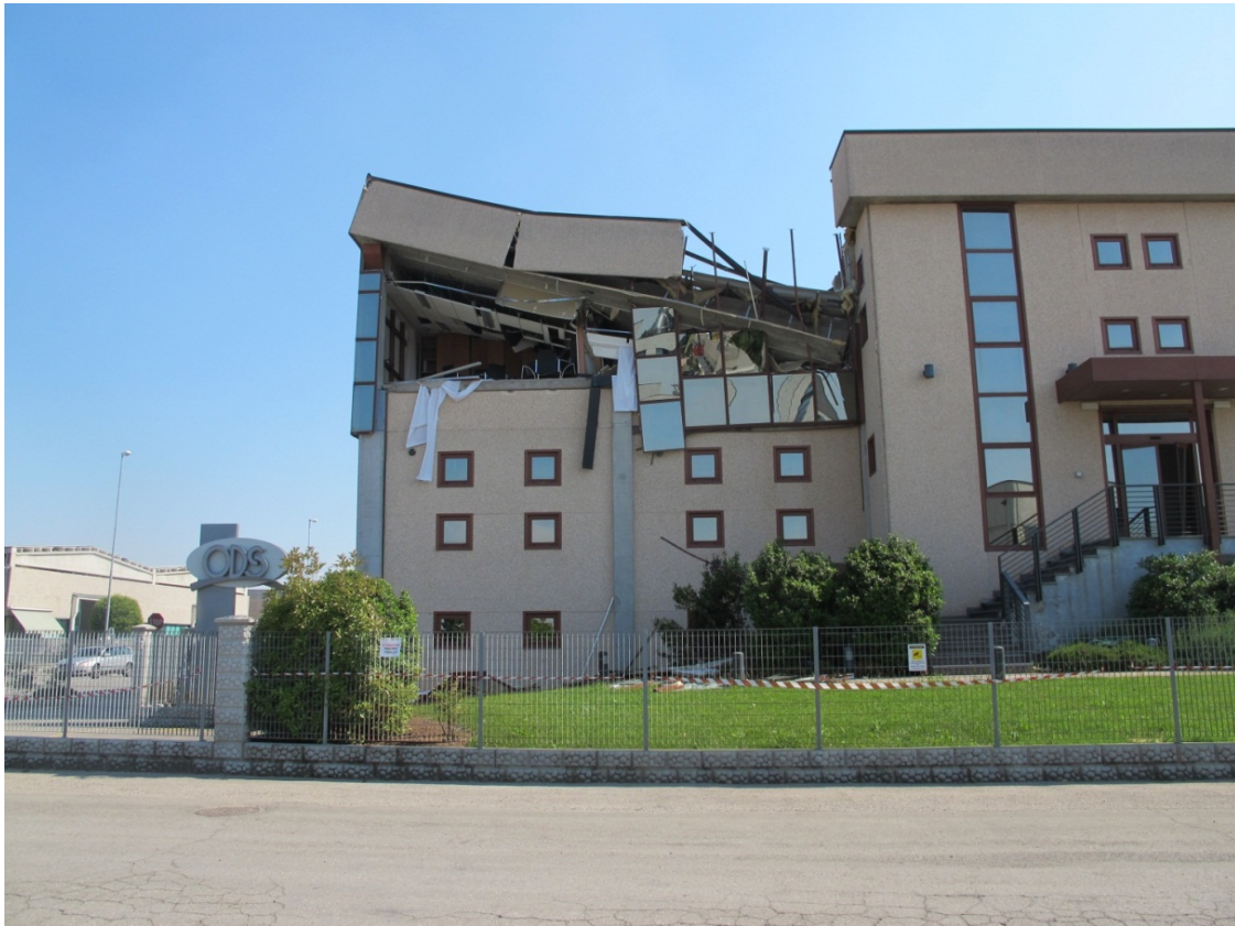
29 Maggio 2012 (dopo 2° sequenza) - Mirandola Nord – Capannone n. 5.
