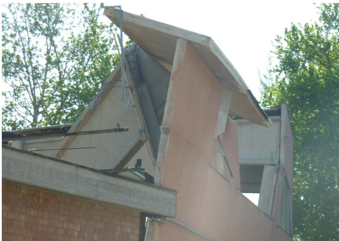
23 Maggio 2012 - S. Felice sul Panaro – Capannone n. 5 (recente).
