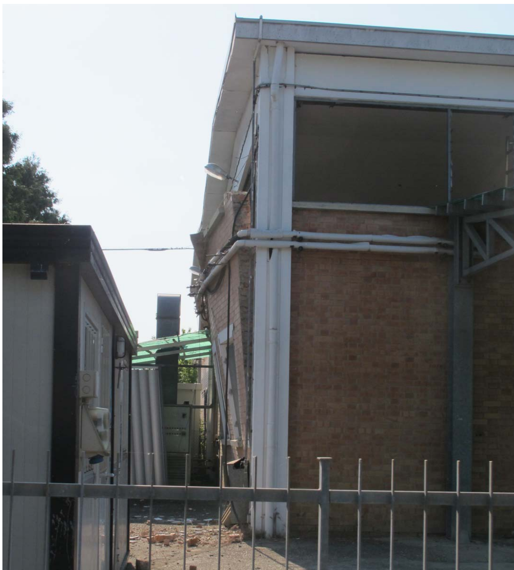
29 Maggio 2012 (dopo 2° sequenza) - S.GR Mirandola – Capannone n. 11.
