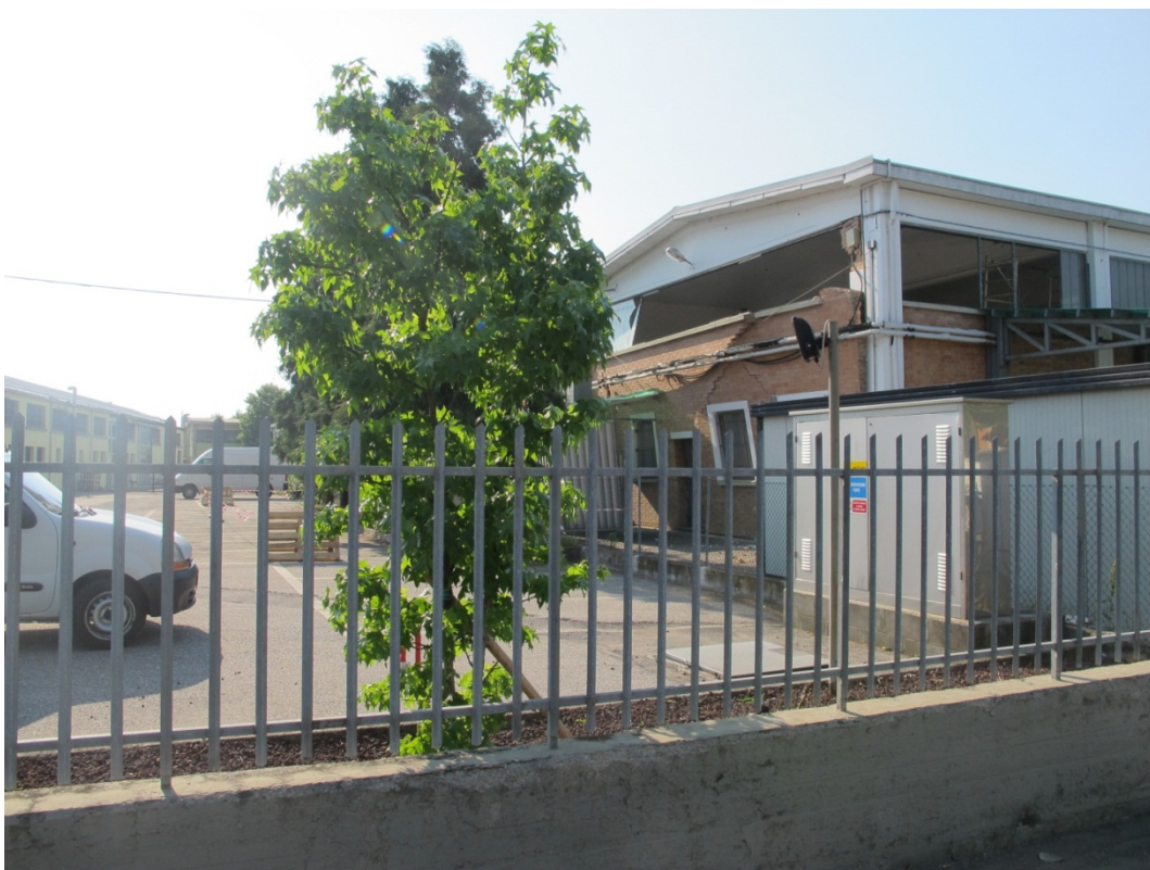
29 Maggio 2012 (dopo 2° sequenza) - S.GR Mirandola – Capannone n. 11.
