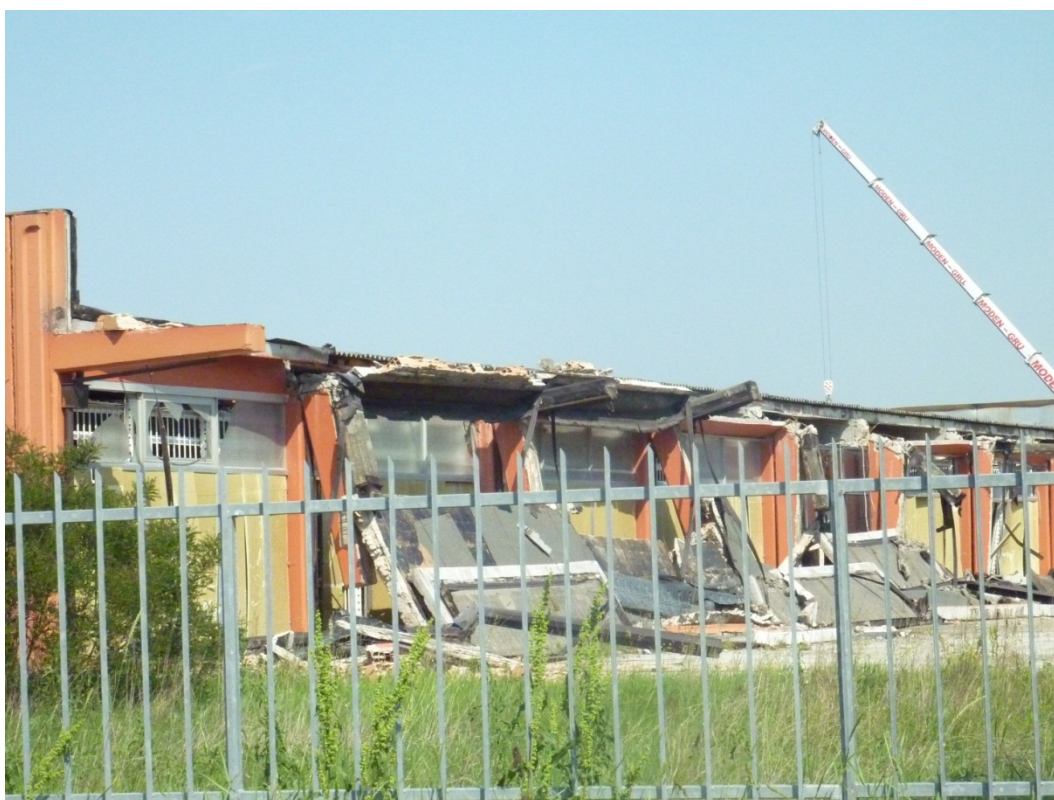
23 Maggio 2012 - S. Felice sul Panaro – Capannone n. 4.
