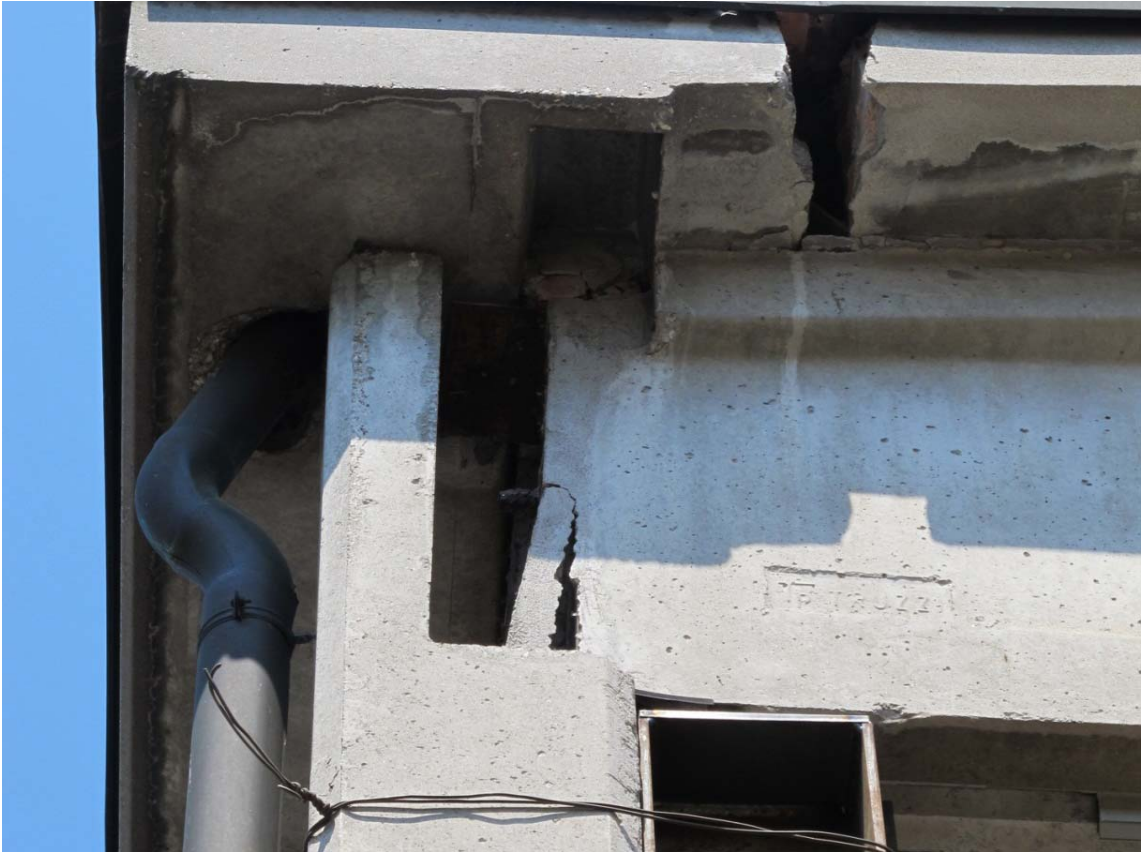
28 Maggio 2012 - S.GR Mirandola – Capannone n. 1 (facciata antistante) – trave con perdita quasi completa dell'appoggio.
