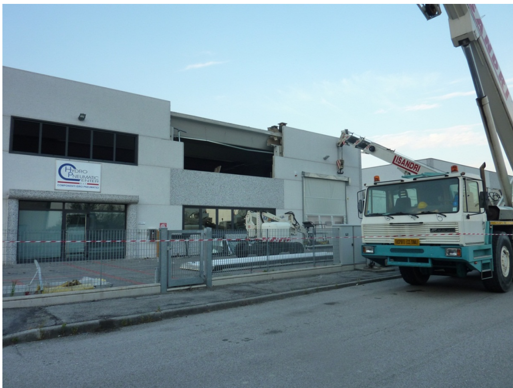
23 Maggio 2012 - S. Agostino – Capannone n. 3 – distacco di tamponatura a pannelli prefabbricati.
