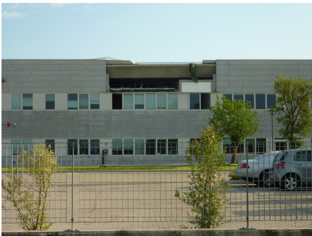
23 Maggio 2012 - S. Felice sul Panaro – Capannone n. 6 – distacco di tamponatura a pannelli prefabbricati.
