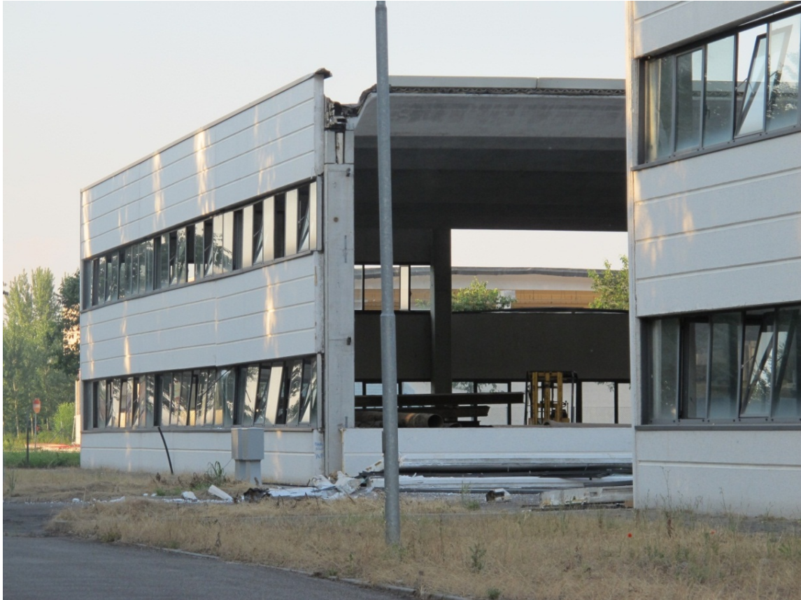
29 Maggio 2012 (dopo 2° sequenza) - S.GR Mirandola – Capannone n. 16 (capannone retrostante).
