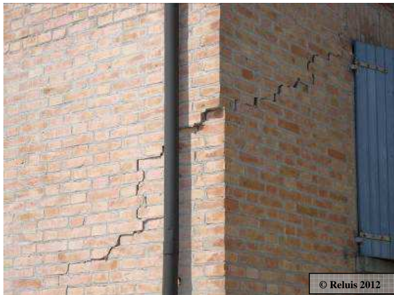
Figura 5 – Camposanto: profonde lesioni a taglio in un edificio in muratura risalente agli anni '50
