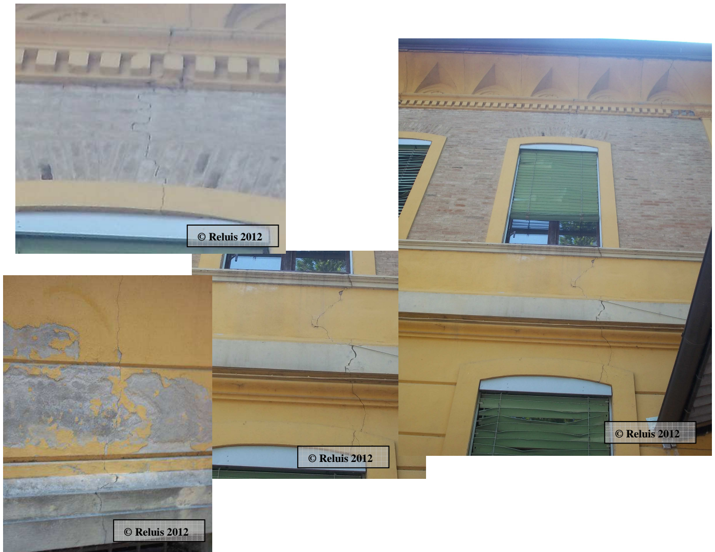
Figura 32 - Numerose Lesioni Verticali da cielo a terra in corrispondenza delle aperture, Vista esterna;
