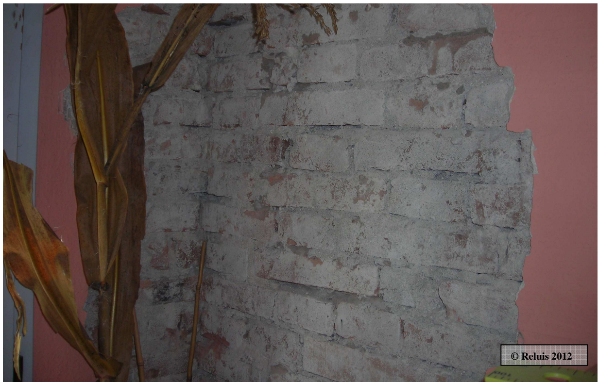
Figura 18 – Pieve di Cento: Scuola De Amicis: Tipica tessitura muraria in mattoni di laterizio con scarso ammorsamento d'angolo
