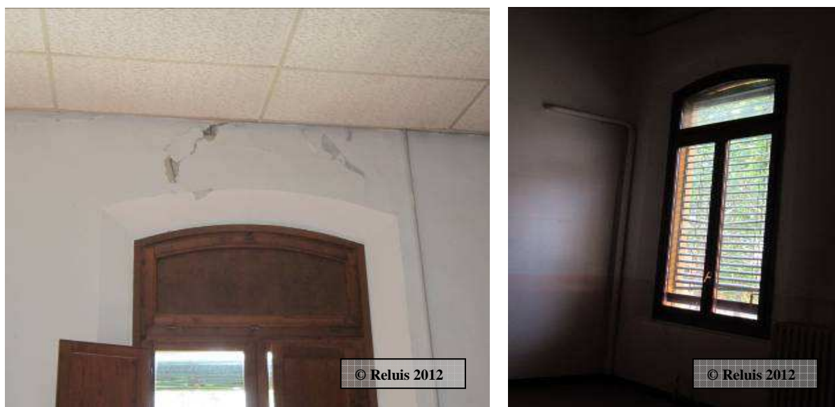
Figura 33 - Vista interna di alcune lesioni in corrispondenza delle aperture.
