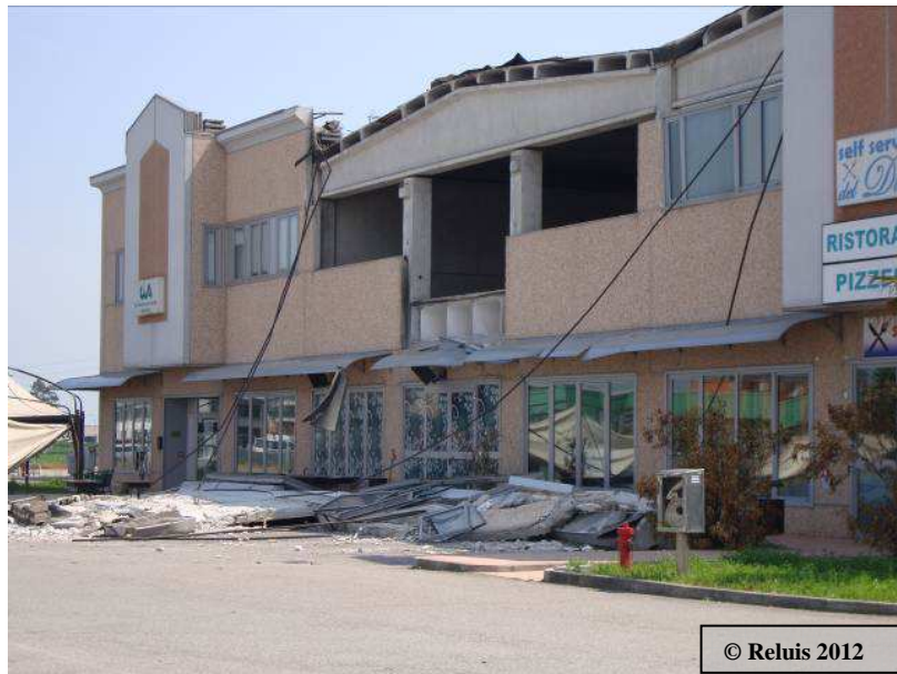
Figura 23 – Medolla: collasso dei pannelli di tamponatura verticali in un edificio commerciale prefabbricato
