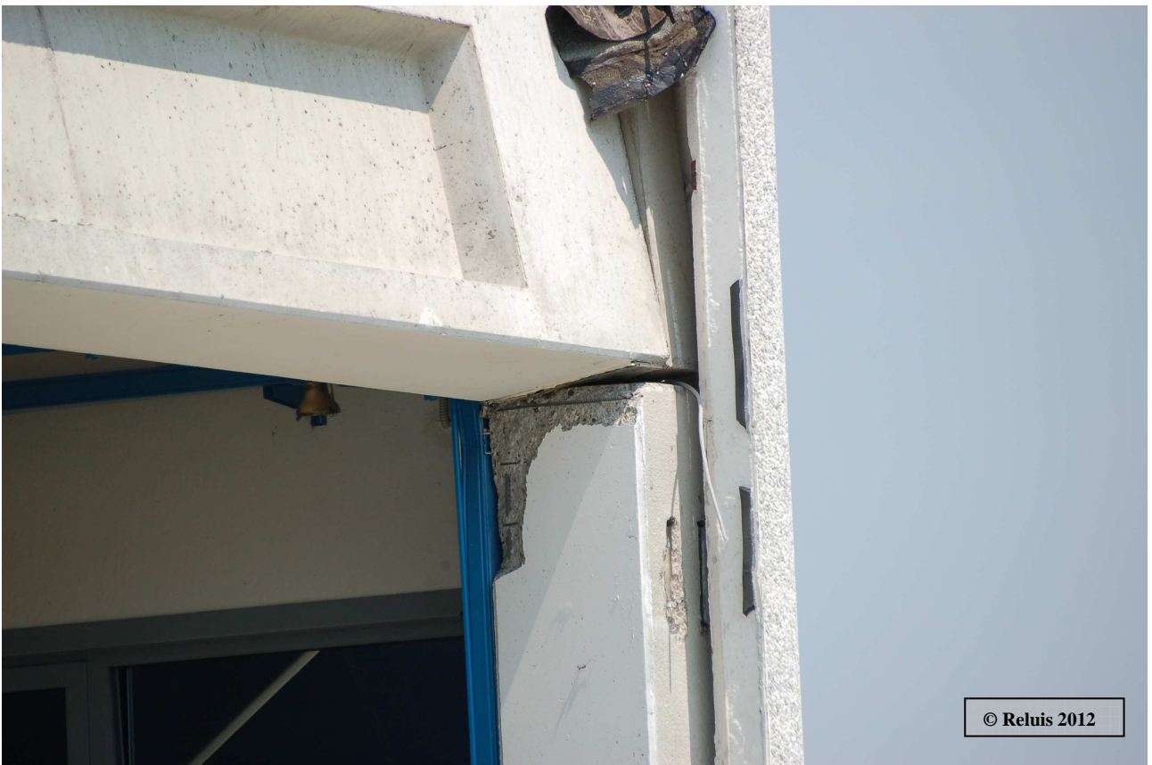
Figura 26 – Medolla: Tipicodanno in corrispondenza degli appoggi delle travi dei capannoni industriali
