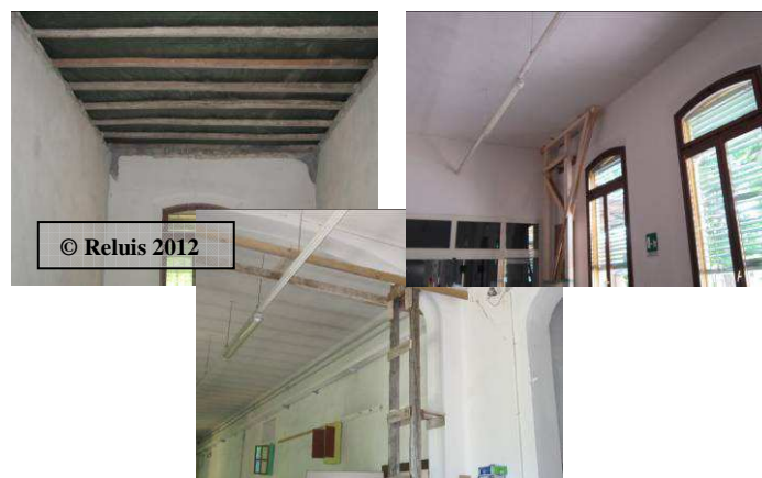
Figura 30 – Alcuni interventi di pronto intervento eseguiti a seguito della scossa del 20 maggio (rimozione di controsoffitto, puntellature).
