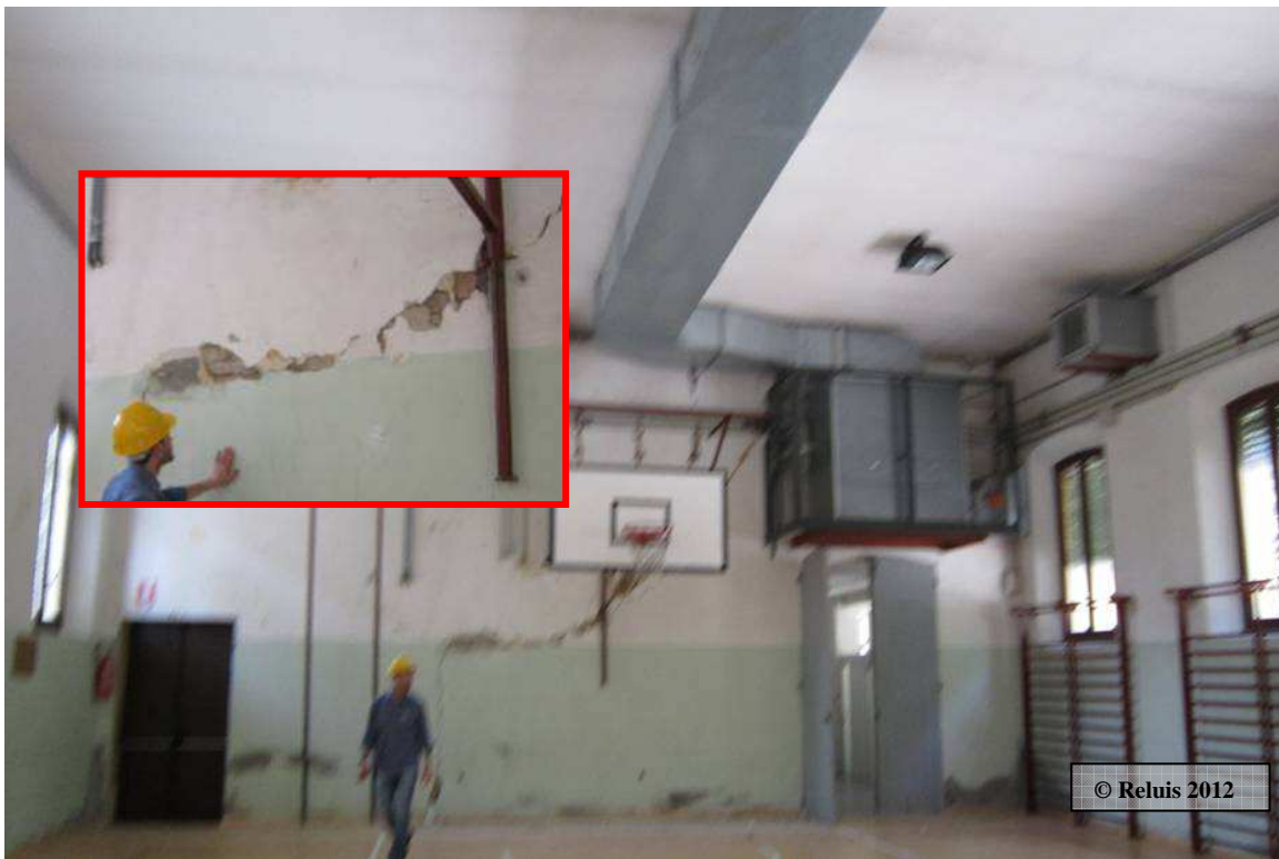
Figura 36 - Alcuni danni rilevati nella palestra
