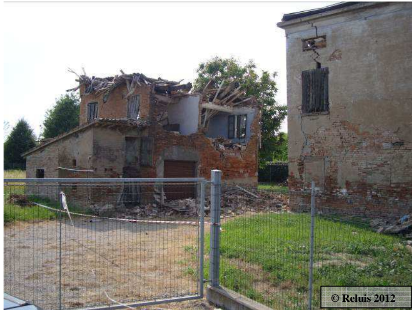
Figura 8 – Medolla: ribaltamento fuori piano di parete muraria e crollo della copertura
