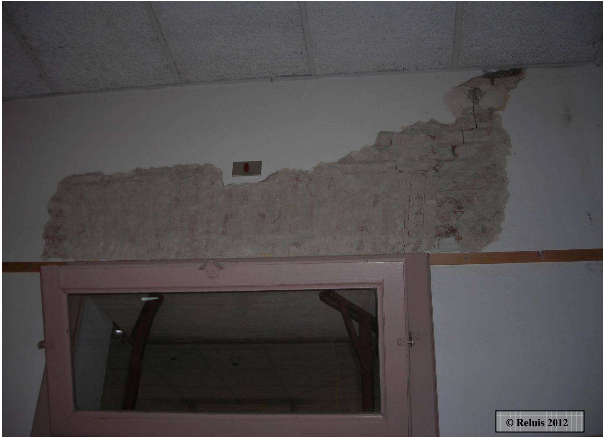
Figura 14 – Pieve di Cento: Scuola De Amicis: Tipico danno in corrispondenza della sommità dei vani interni per assenza di un efficace piattabanda (arco molto ribassato con mattoni disposti di coltello)
