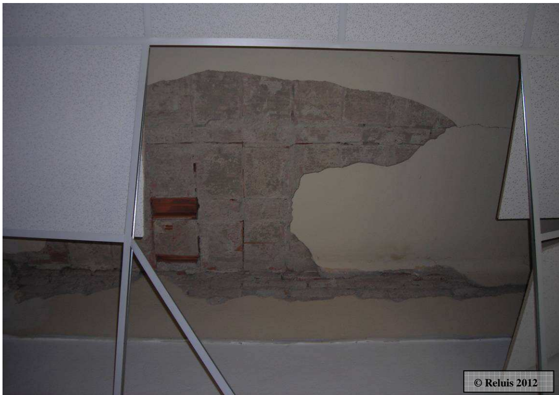
Figura 19 – Pieve di Cento: Scuola De Amicis: Collasso delle pannellature di controsoffitto per caduta dei fondelli di laterizio del solaio
