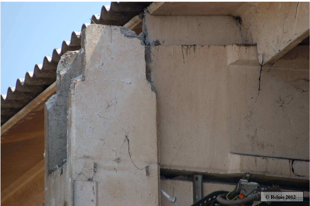
Figura 27 – Medolla: Tipico danno in corrispondenza degli appoggi delle travi dei capannoni industriali
