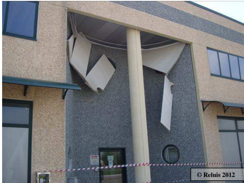
Figura 22 – Medolla: caduta di controsoffitti in cartongesso in un edificio commerciale prefabbricato pluripiano
