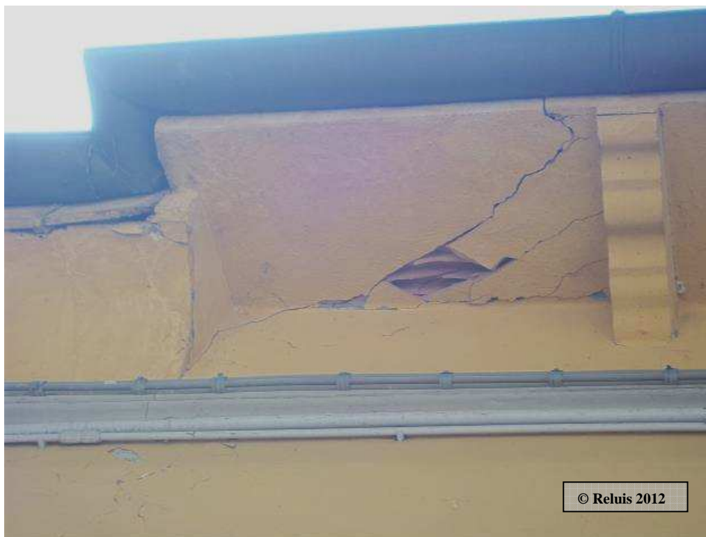
Figura 31 – Caduta e rischio di caduta di elementi di cornicioni e modanature
