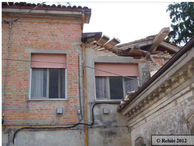
Figura 13 – Medolla: ribaltamento fuori dal piano di parete muraria e collasso della copertura
