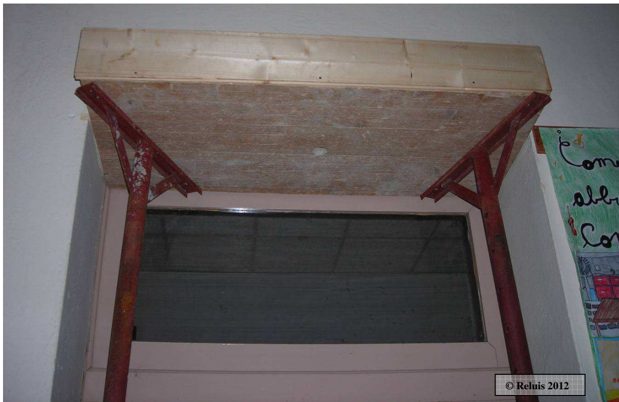
Figura 15 – Pieve di Cento: Scuola De Amicis: Interventi provvisionali eseguiti dopo il sisma del 20 maggio in corrispondenza di alcuni vani di passaggio
