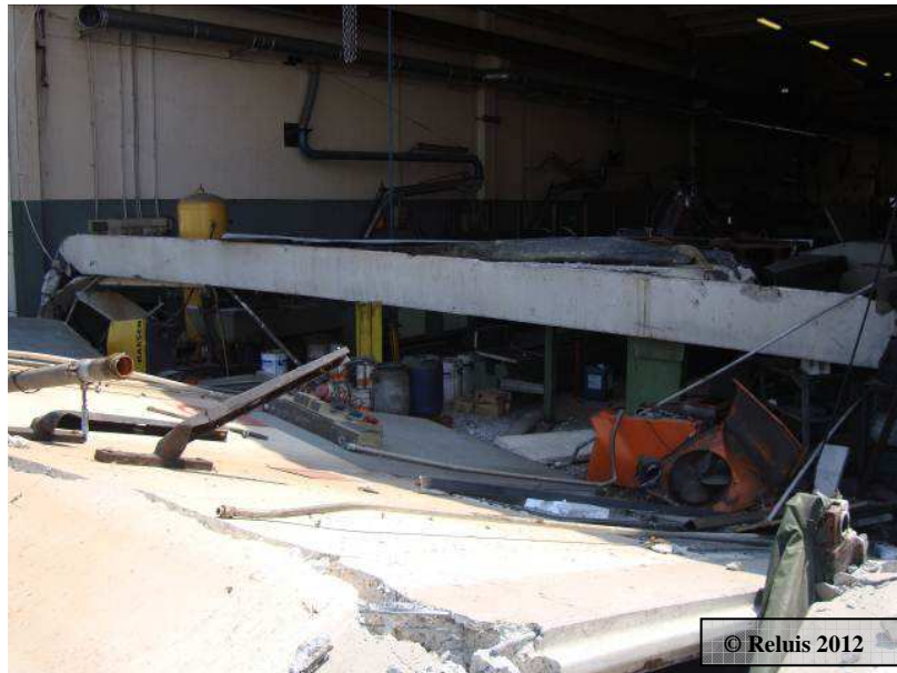
Figura 21 – Medolla: crollo di pannelli di tamponatura verticali e collasso delle travi di gronda in un edificio monopiano prefabbricato ad uso industriale
