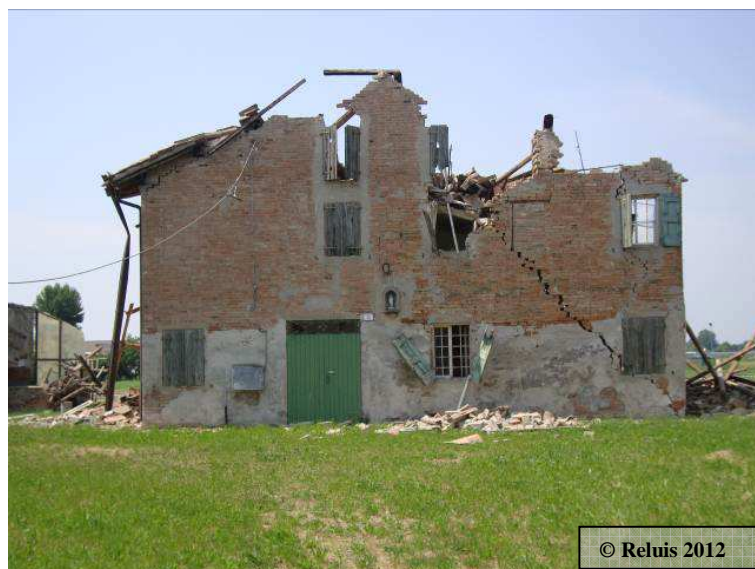
Figura 7- Medolla: collasso totale di edifici in muratura.
