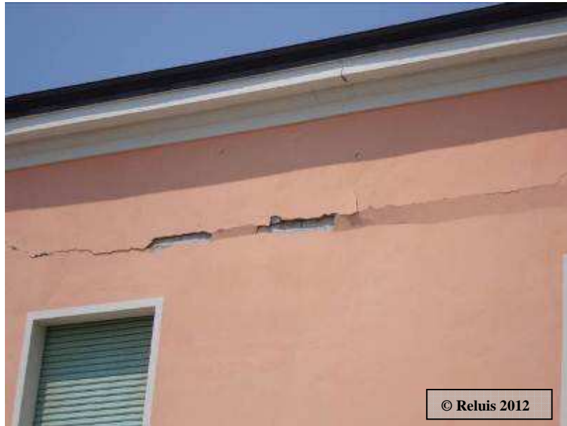
Figura 2 – Camposanto: fessurazione orizzontale in un edificio in muratura in prossimità della copertura
