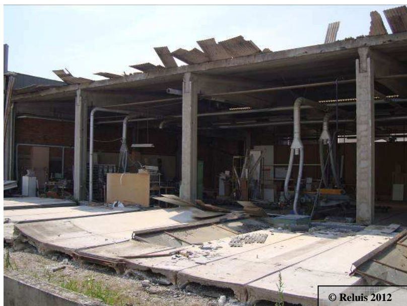
Figura 24 – Medolla: Crollo di pannelli di tamponatura verticali di un edificio prefabbricato
