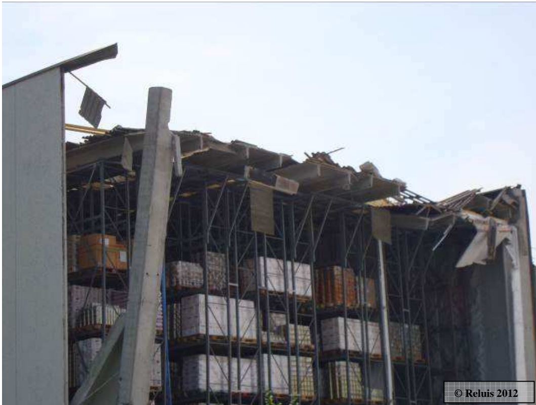
Figura 25 – Medolla: collasso di tegole di copertura e dei pannelli di tamponatura in un edificio monopiano prefabbricato
