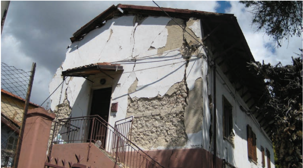
Figura 2.6. Lesione nel cantonale di un edificio in muratura (foto: A. Balsamo, I. Iovinella, A. Prota).
