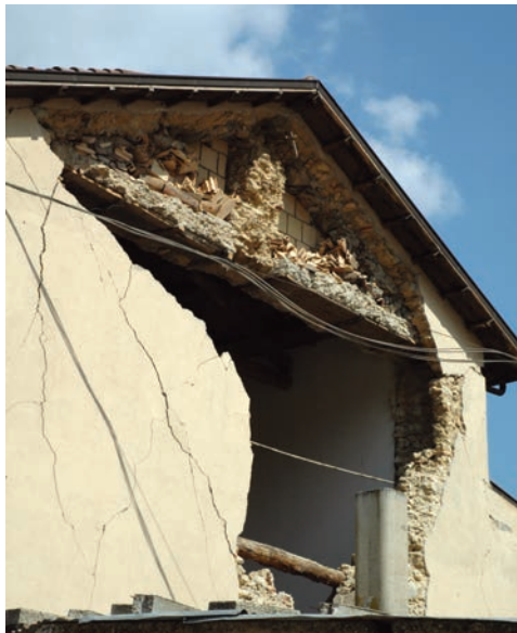
Figura 2.8. Crollo per ribaltamento fuori dal piano di parete perimetrale (foto: A. Balsamo, I. Iovinella, A. Prota).
