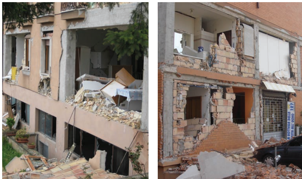
Figura 2.13. Danni alle tamponature: ribaltamento fuori dal piano (sinistra); Crolli parziali della tamponatura e distacchi della fodera esterna (destra) (foto: M. Di Ludovico, G.P. Lignola).
