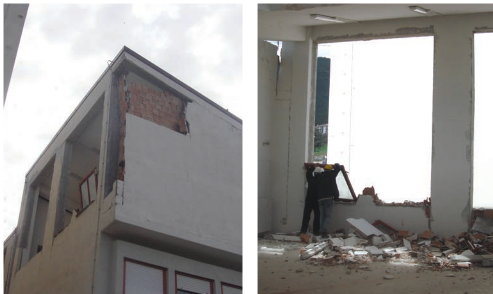
Figura 2.12. Crollo ed incipiente ribaltamento di tamponature: vista esterna (sinistra); vista interna (destra) (foto: M. Di Ludovico, G.P. Lignola).
