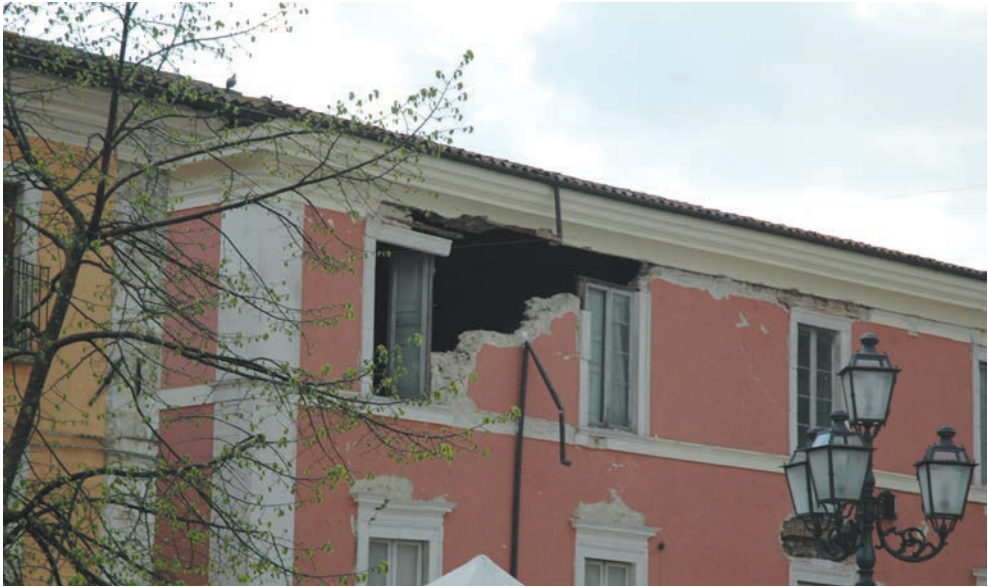
Figura 2.7. Crollo per ribaltamento fuori dal piano di pannello murario di sommità (foto: A. Balsamo, I. Iovinella, A. Prota).
