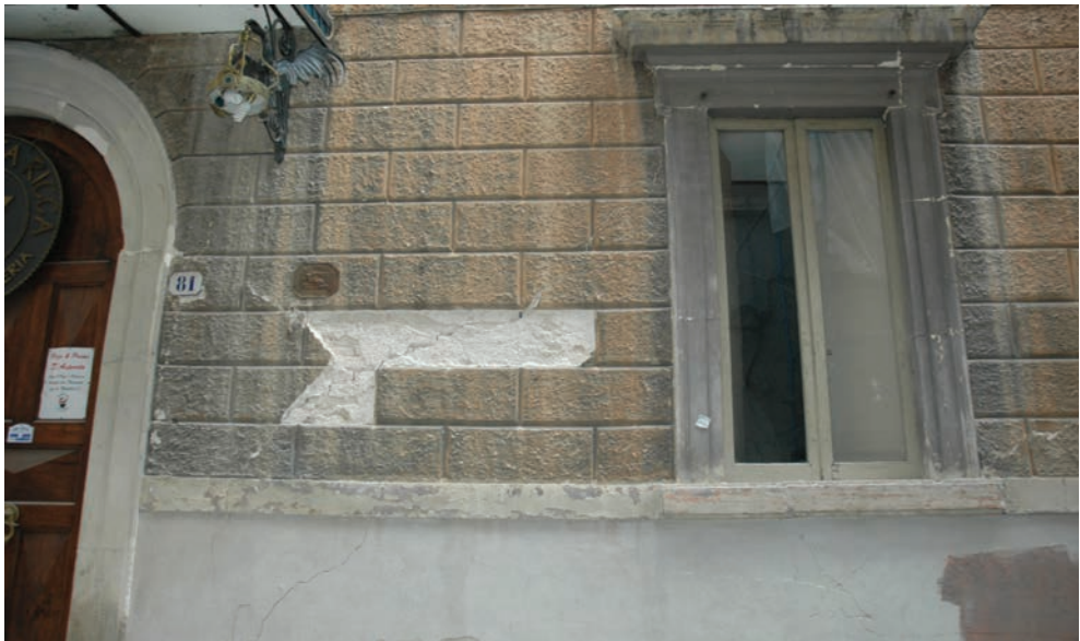
Figura 2.9. Lesione in un pannello murario di facciata (foto: A. Balsamo, I. Iovinella, A. Prota).
