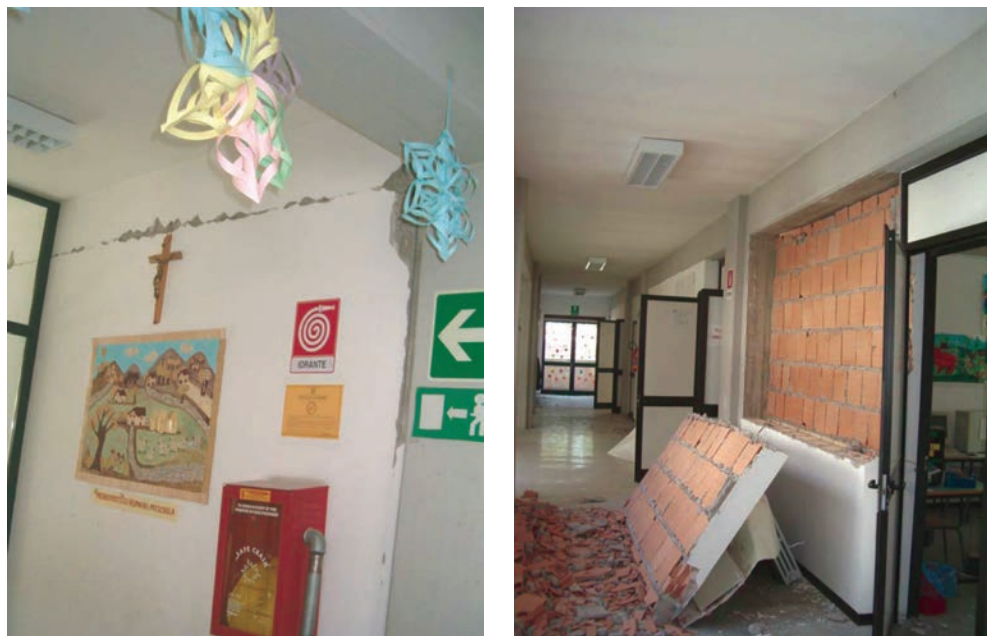
Figura 19. Danni alle partizioni: distacco all'attacco tramezzatura-trave (sinistra); ribaltamento di una delle fodere del tramezzo sul corridoio (destra) (foto: S. Sorace, G. Terenzi).
