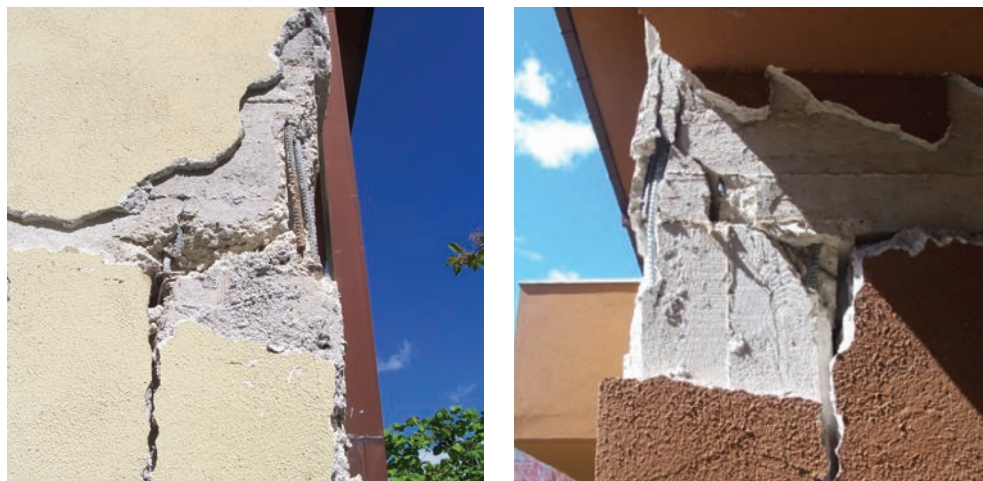
Figura 2.1. Nodo danneggiato dal sisma: lesione pseudo-orizzontale all'attacco pilastro-pannello (sinistra); lesione diagonale nel pannello (destra) (foto: O.S. Bursi, T. Dusatti, R. Pucinotti).
