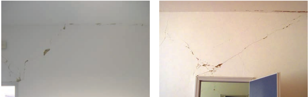
Figura 2.16. Danni alle partizioni: lesioni all'attacco tramezzatura-trave ed in corrispondenza delle aperture (sinistra); lesioni sulla porzione sovrastante l'apertura (destra) (foto: F. Ceroni, M. Di Ludovico, A. Romano).
