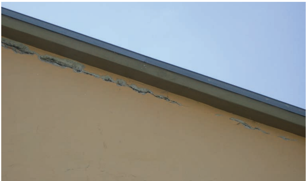
Figura 2.10. Lesioni di distacco tra il cordolo della copertura e la parete in muratura (foto B. Calderoni, E. Cordasco, L. Migliaccio).
