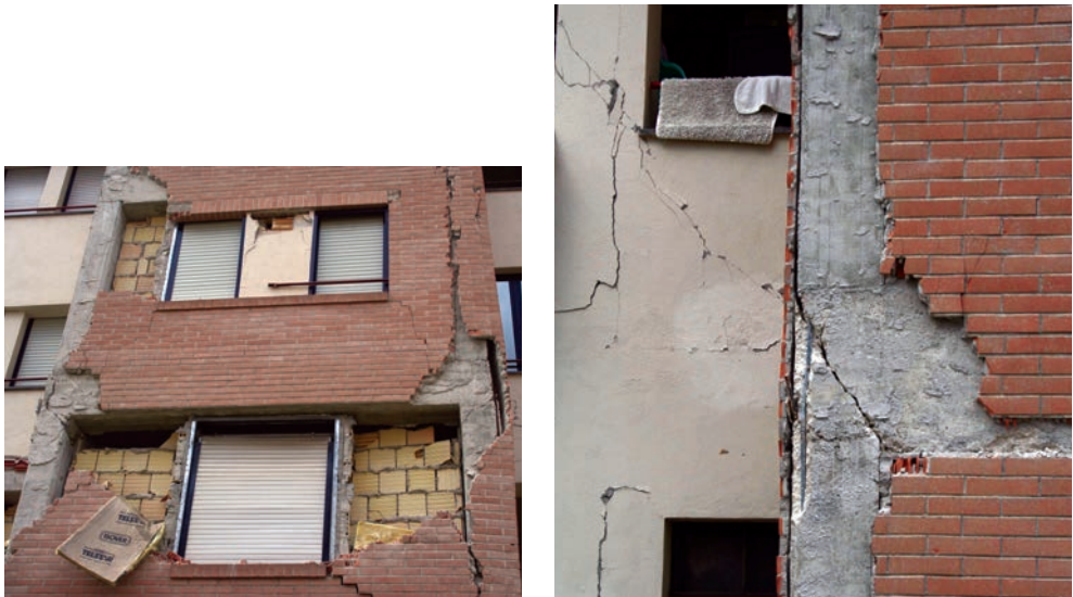
Figura 2.4. Nodo danneggiato dal sisma: vista d'insieme (sinistra); particolare di uno dei nodi trave-pilastro (destra) (foto: I. Iervolino, A. Prota, P. Ricci, G.M. Verderame).
