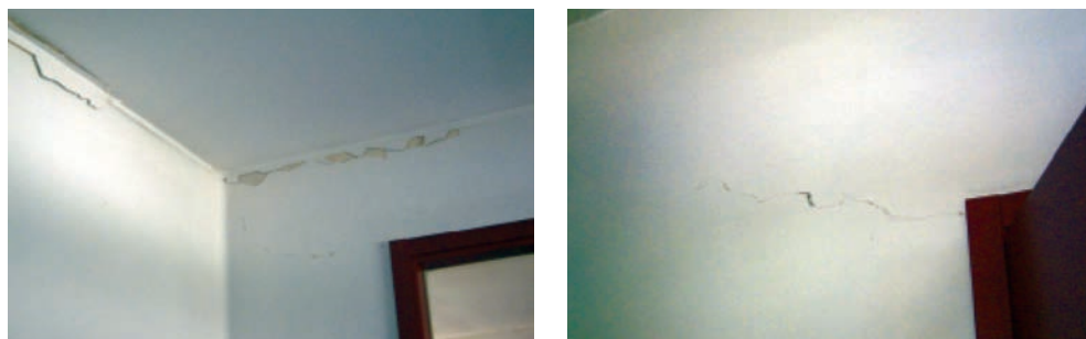
Figura 2.15. Danni alle partizioni: lievi lesioni attacco tramezzatura-trave con parziale distacco intonaco (sinistra); lievi lesioni sui tramezzi in corrispondenza delle aperture (destra) (foto: D. Abbruzzese, R. Vittorini, F. Destefano, L. Miccoli, Z. Quian).
