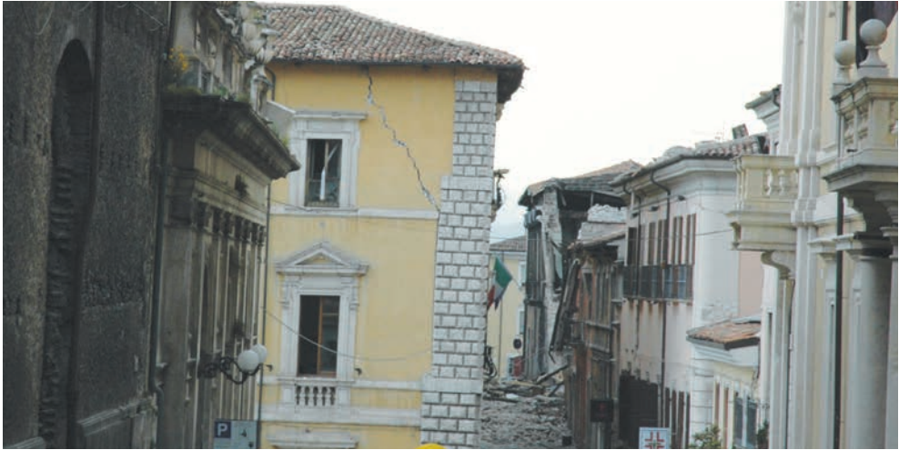
Figura 2.5. Lesione in pannello murario di sommità dovuta ad attivazione di meccanismo di ribaltamento fuori dal piano del paramento ad esso perpendicolare, grazie al buon ammortamento nello spigolo (foto: A. Balsamo, I. Iovinella, A. Prota).
