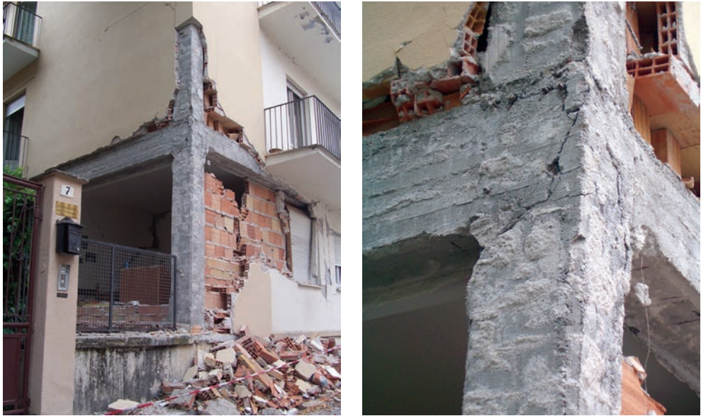
Figura 2.3. Nodo danneggiato dal sisma: vista d'insieme (sinistra); particolare del nodo trave-pilastro (destra) (foto: O.S. Bursi, T. Dusatti, R. Pucinotti).
