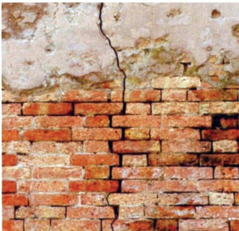
Figura 3.90. Paramento murario danneggiato su cui verrà realizzato intervento di scuci e cucì.
