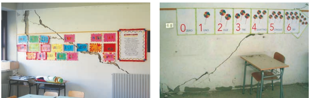
Figura 2.18. Danni alle partizioni: lesioni diagonali sui tramezzi (foto: S. Sorace, G. Terenzi).
