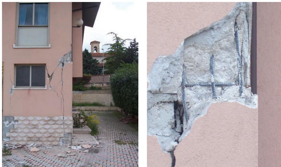
Figura 2.2. Nodo danneggiato dal sisma: vista d'insieme (sinistra); particolare del nodo trapezoidale (destra) (foto: O.S. Bursi, T. Dusatti, R. Pucinotti).
