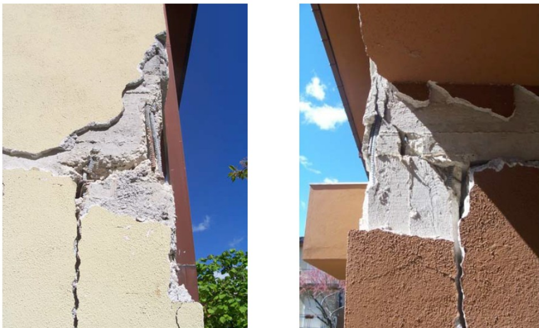
Figura 0-1: Crisi dei nodi trave-pilastro in c.a. a seguito dei recenti eventi sismici
