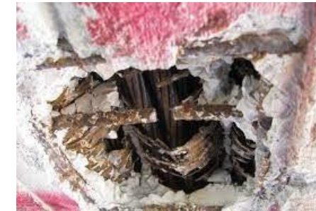
(Tubi non iniettati e cavi corrosi)
