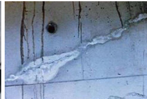
Lesioni lungo i cavi
