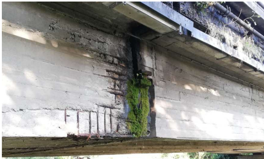
problemi di degrado che incidono sulla durabilità dei ponti: la corrosione dell'acciaio
